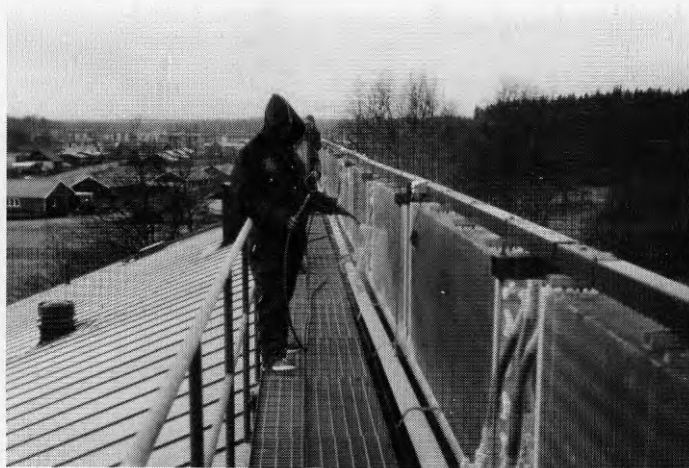
Figur. Foto på vattenbesprutning av vind- konvektorerna för kontroll av av- frostningsfunktionen.
