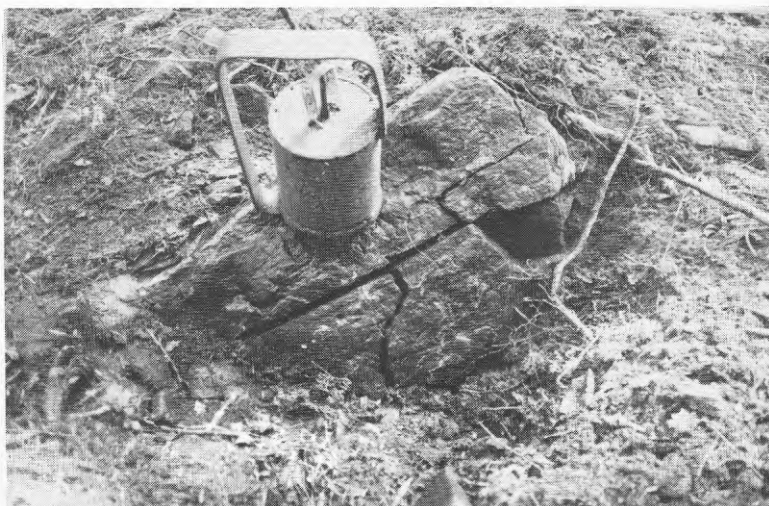
Fig. 3.1 b. Fotot visar bergkant som förspräckts med gasspräckare och sedan särlagts med patronspräckare i st. f. med sedvanlig kilning.
