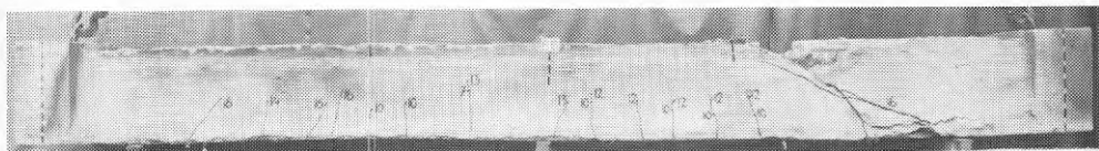
Bild B6:1 balk B6 fick skjuvbrott. Bröttsprickan går ungefär från upplagsboken till höger upp till gropen i balkens överkant.
