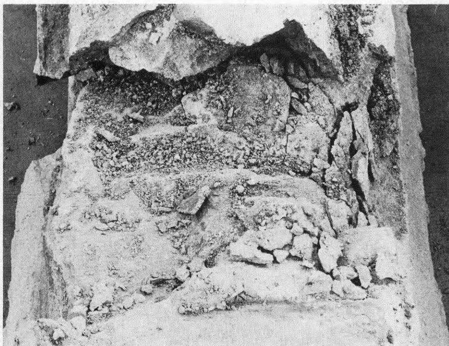
Bild B3:4 Brottstället sett snett uppifrån från mitten mot norra balkänden.
