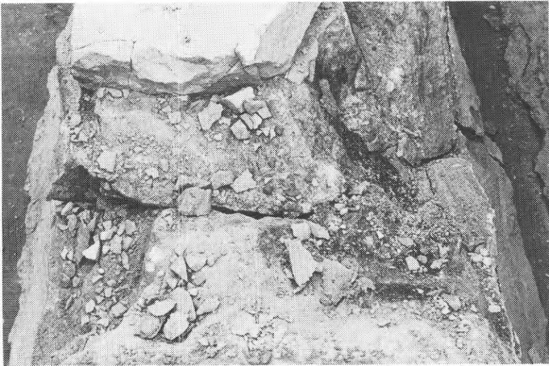
Bild B6:6 Detalj av tryckzonen tagen snett uppifrån från balkens mitt mot balkens södra ände, ungefär parallellt med skjvsprickan.
