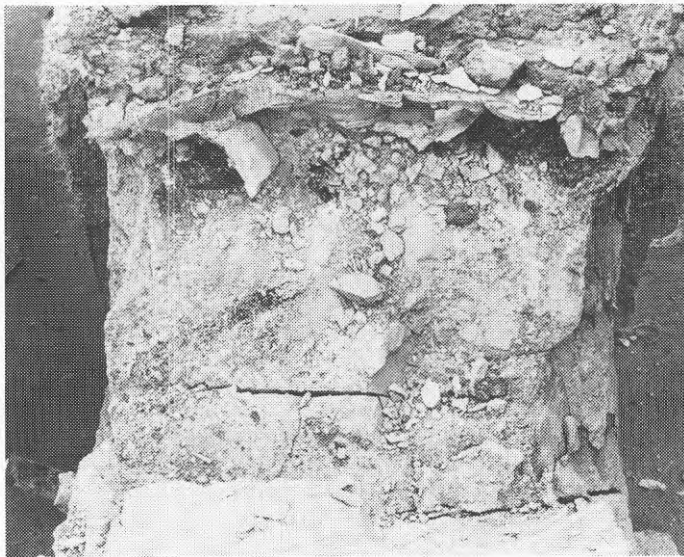
Bild B2:4 Brottstället sett snett uppifrån från balkmitt mot norra balkänden.
