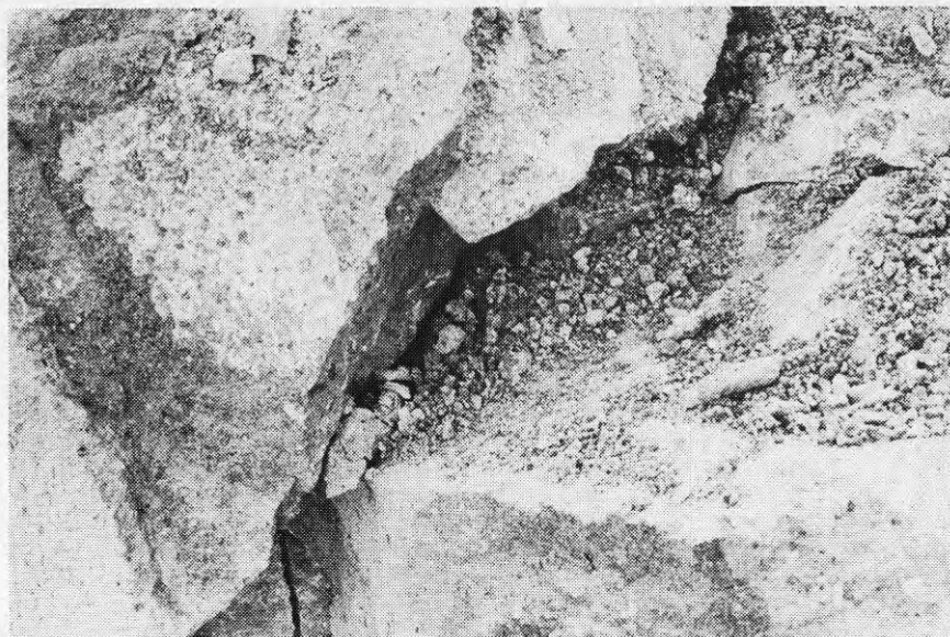
Bild B3:3 Brottstället sett i närbild snett uppifrån och från sidan. Observera håligheter i betongen under stenarna.
