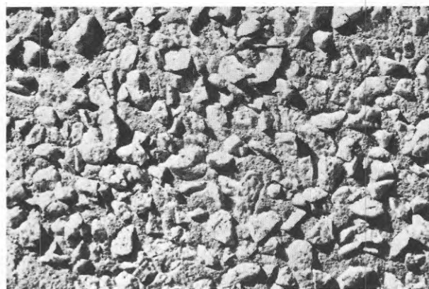
38 grå fasadbetong, synlig ballast
