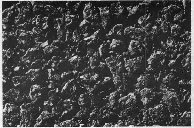
10 svart fasadbetong, synlig ballast
