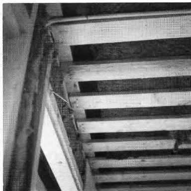
b) Fotografi visande iakttaget fel i isolerutförandet. (PE-folie ej monterad här)
