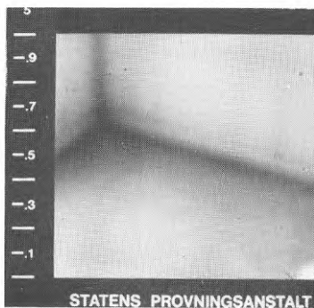
b) Termogram av ytparti vid golvvinkel. Tillfredsställande täthet erhöles med detta system.
