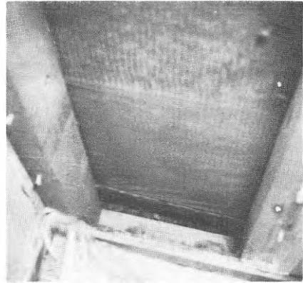
b) Fotografi från insidan av den yttre mineralullsskivans anläggning mot reglarna. Vid den nedre horisontella syllan ligger skivan ej dikt an mot syllan. En spalt på 3 cm föreligger här.
