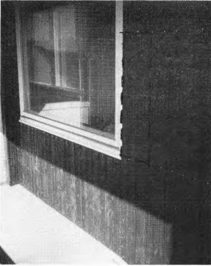
a) Solbelysning på fasaden kl 09.00. Ytparti med reducerad isolering har markerats.
