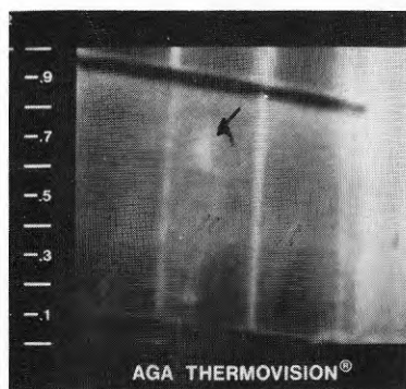
c) Termogram av väggpartiet. Här framträder ett varmt område mitt på det isolerade väggfältet. Uppvärmningen här har samband med utläckande varm luft.
