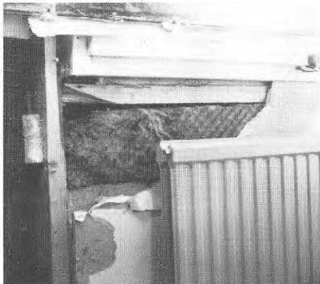
b) Fotografi av frilagt väggparti. Bristfälligt anpassat isoleringsmaterial.
