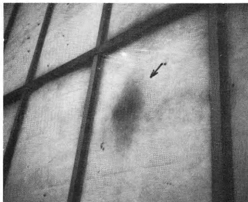
b) Fotografi av yttervägg från insidan. Ett mörkare (nedsmutsat) ytparti framträder mitt på väggfältet. Nedsmutsningen har orsakats av utläckande, smutsig innerluft genom lokala otätheter hos väggpartiet.
