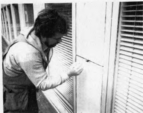
Figur 6.1c Fogytor grundas (eventuellt). Grundningen väljs enligt fogmasselieferantörs föreskrifter för aktuell fogmassa och byggnadsmaterial.
