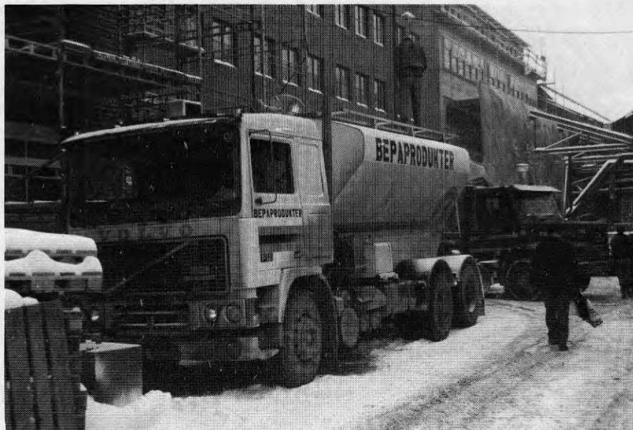
Fig 3. Pumpbil för pumpning av flytspackel. Materialföretaget tillhandahåller bil med förare. Denna omsörjer blandning och pumpning. Mottagning och utläggning skötes av byggföretaget. Normalt åtgår 2 man för detta.
