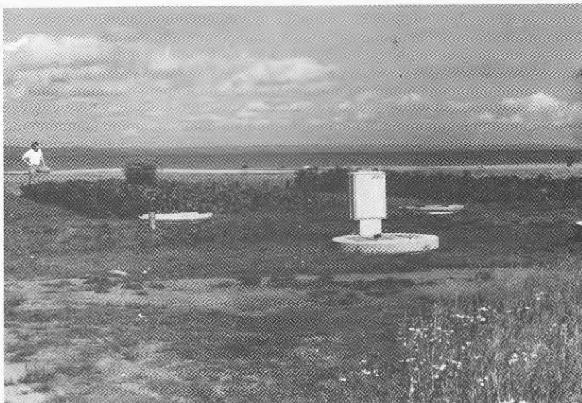
Pumpstation och markbädd i Säby-området, Visingsö. Lagg märke till grönsaksodlingen
