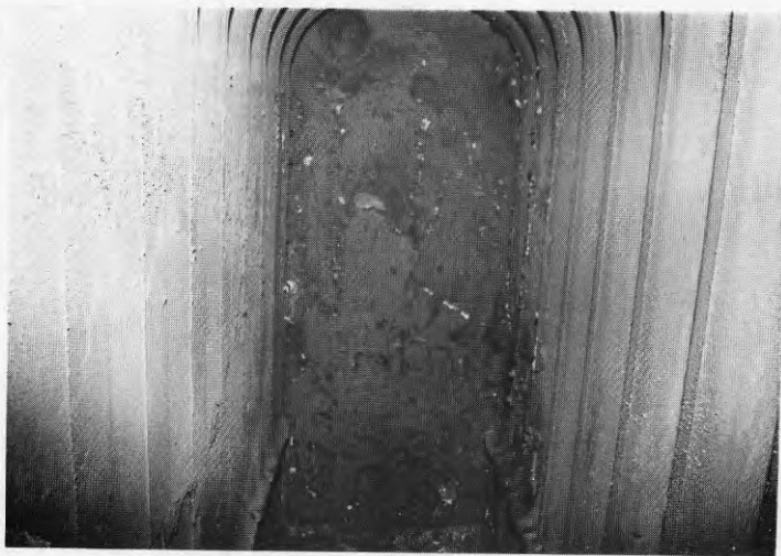
Figur 2.3. Foto av pannans eldstadsutrymme före installation av rökgaskylare.
