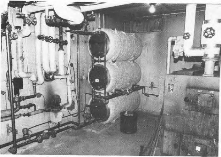
Figur 2.5. Ackumulatortankar för lagring av förvämt varmvatten.
