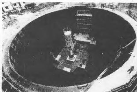
Värmemagasin för solenergi. Lambohov, Linköping.
