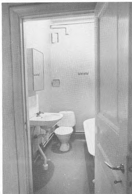
Figur 6.17 Uteluftsdon och frånluftsdon i badrum. Här är handfat och WC-stol nya
