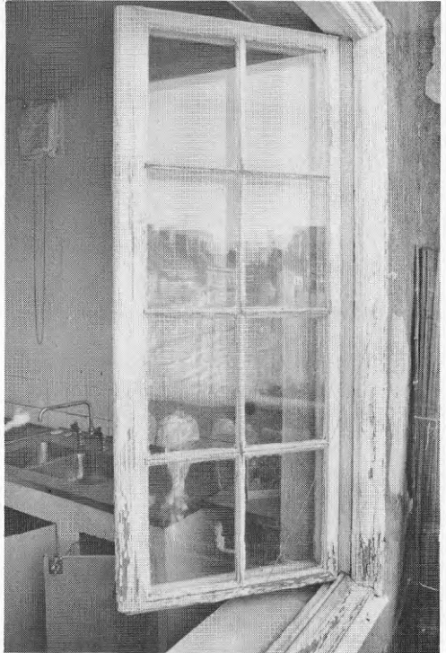
Inåtgående fönster med 2-glasrutor och spröjsar, i starkt behov av renovering. →
