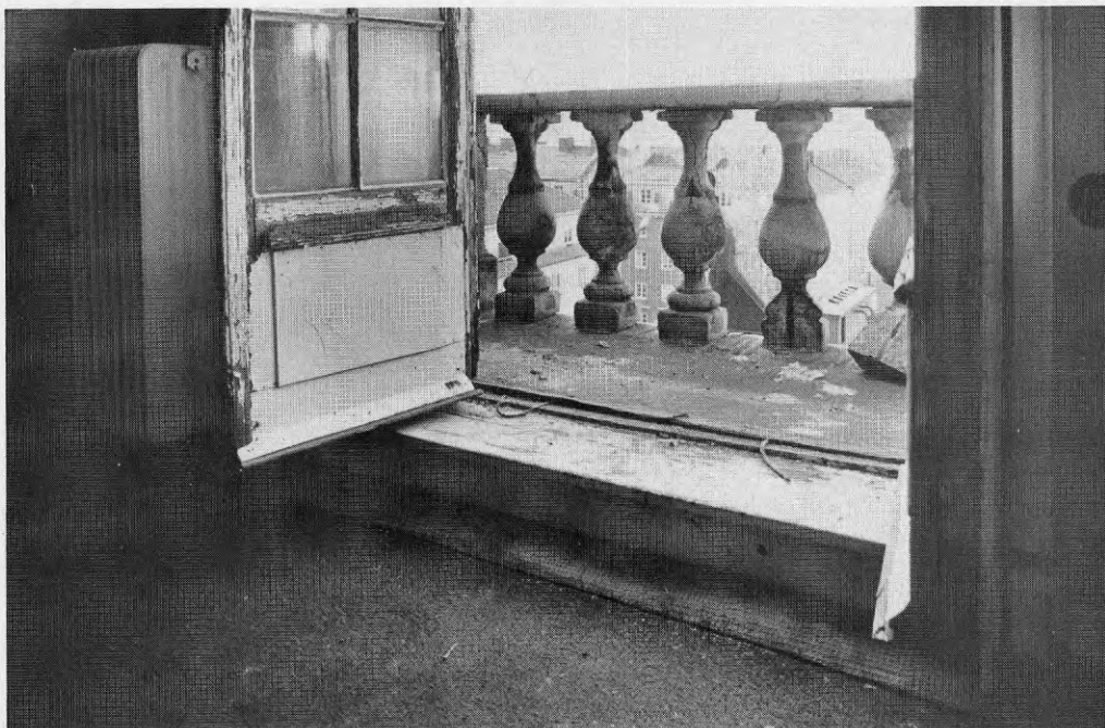
Betongdockorna på altanerna var i dåligt skick och mycket låga.
