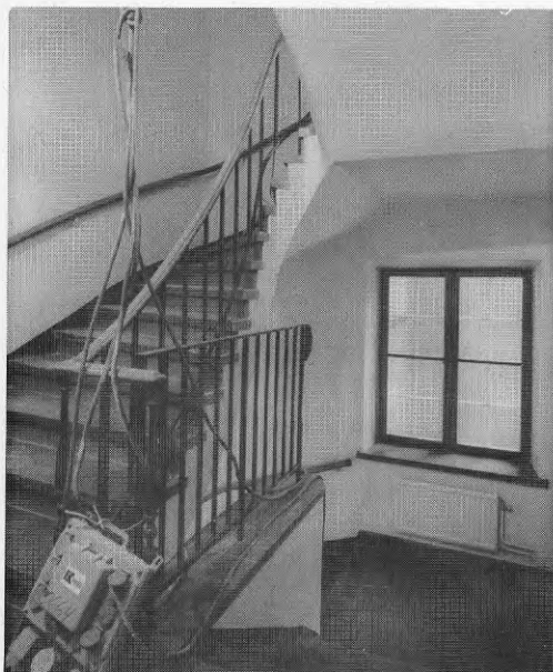
Trappräckena fick behållas trots att de var låga och glasa, men måste kompletteras vid den plana avsatsen längst ner.
