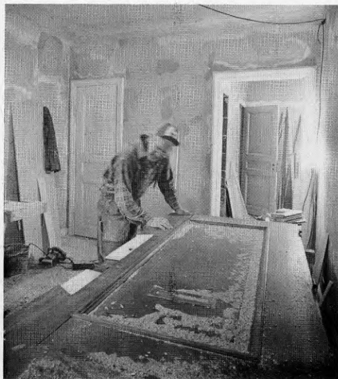
Tamburdörrarna av ek bevarades och fick nya lås. Hålen efter de gamla lagades genom att nya ekstycken fälldes in. Ett tidkrävande och kvalificerat arbete, som ändå lönade sig.
