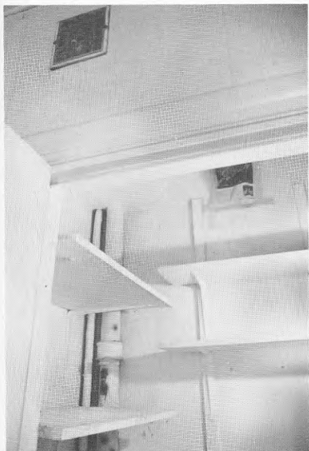
Figur 6.14 Frånluftsdon i boningsrum. Obs det sönderrostade avloppsröret i garderoben
