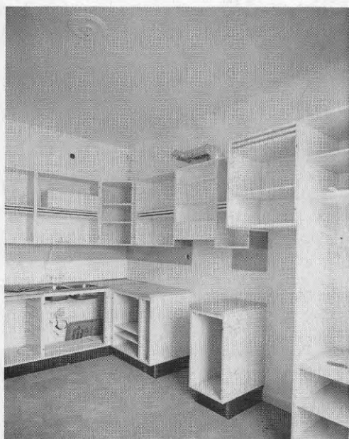
Köken fick fläkt och spiskåpa. Här saknas ännu kåpan och inklädnaden av fläktröret ovan överskåpen.
