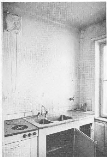
Figur 6.16 Frånluftsdon i ett kök som rustats upp under senare år med bl a rostfri diskbänk
