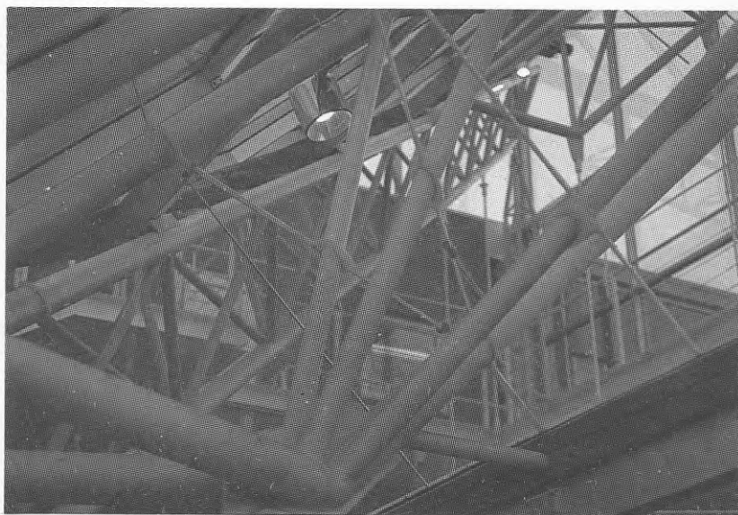
BILD 2.1 C Olämplig anslutning där stammen skär igenom glaskonstruktionen.
