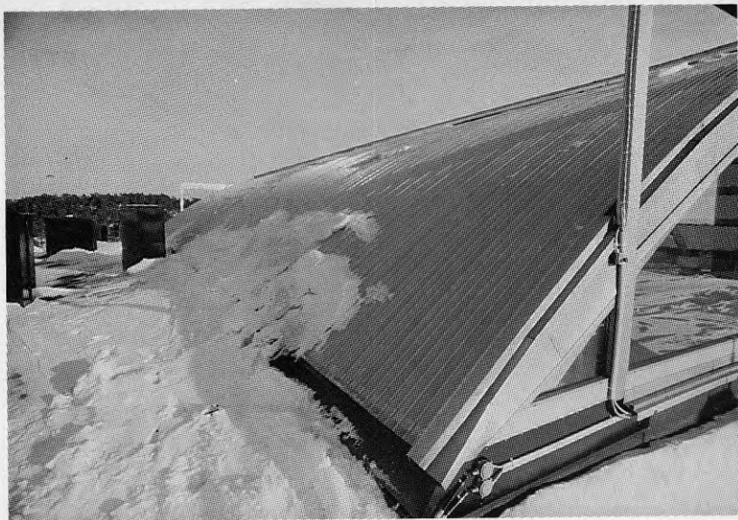
BILD 2.1 D En låg sarg innebär att det inte finns plats för snön att glida av. Stor risk för påfrysning och att isvallar byggs upp. Stor risk för läckage.
