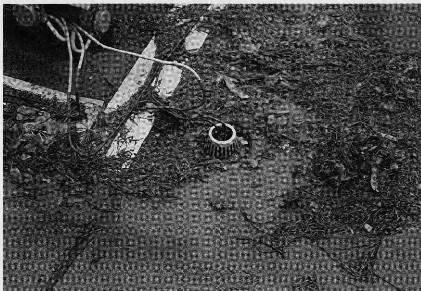
BILD 2.1 F Underdimensionerade eller igensatta brunnar kan innebära översvämning med läckage som följd.
