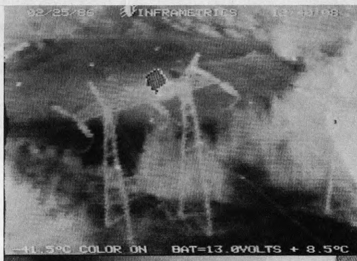
Figur 3:1. Mast med uppvärmda dämpare på faslinorna. Upptagning med Inframetrics.
