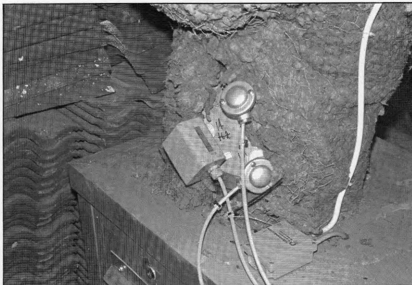
Fig 4.6 Här ses den vindsplacerade värmeåtervinningsdelen i hus 8 med temperatur- och fuktgivare i de anslutande kanalerna.
