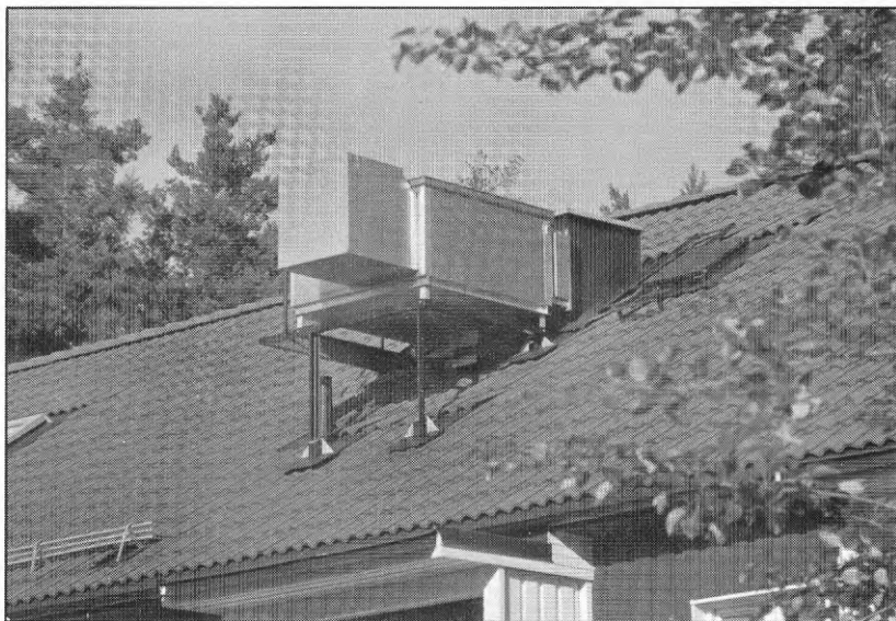
Fig 3.1 Fyra av husen har försetts med värmepumpar för direktförångning från Parca placerade direkt på yttertak.
