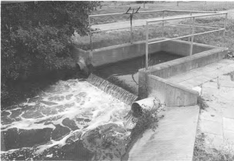
Figur 2.3. Utsläpp av avloppsvatten till recipient. De två plast-rören kommer från värmepumpen.
