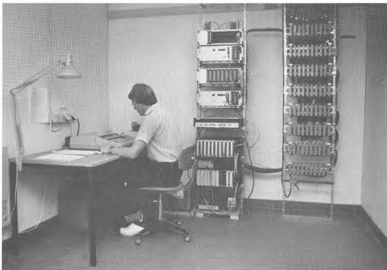
Bild 7 Datorrum med datateknisk utrustning
