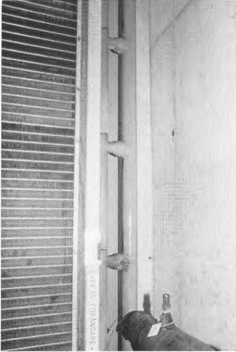
Fig 8.3.6. Detaljbild av förångare med fördelningsrör, Komarken.
