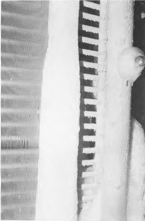
Fig 8.2.8. Detaljbild på kylbatteri med fördelningsrör.
