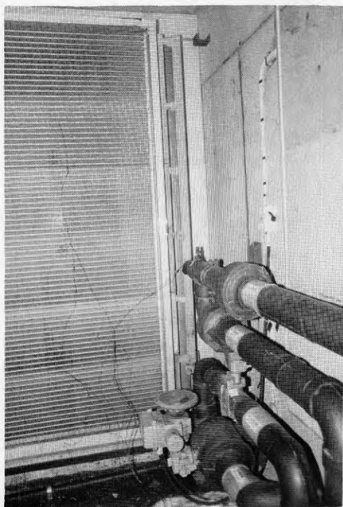
Fig 8.3.5. Förångare med motorventiler, Komarken.
