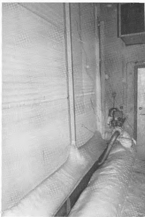
Fig 8.2.10. Intagssida på kylbatteriet vid ett relativt frostigt tillstånd.
