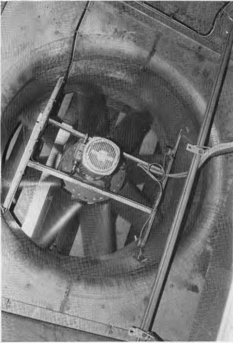
Fig 8.2.9. Fläkt placerad i taket på varje sugkammare.
