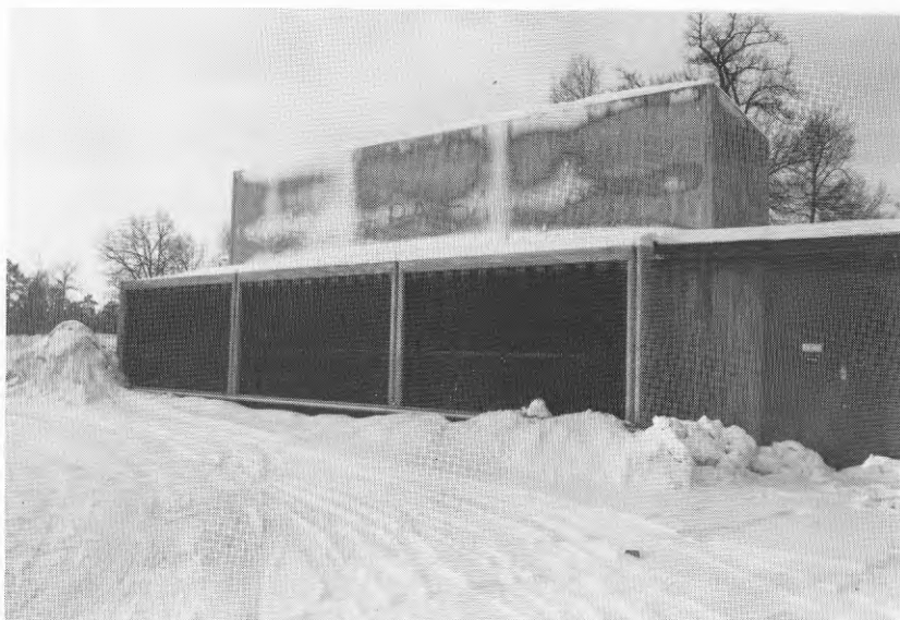
Fig 8.2.3. Fagersjöanläggningen, visande intagsgallren för uteluften.
