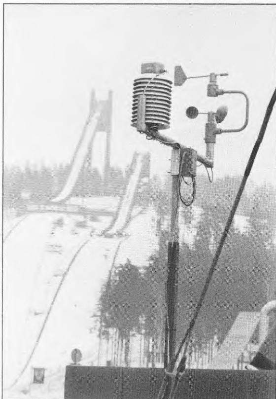
Fig 5.11 Mätvärdes- givare för utomhustempera- tur och vind mont på entre vid ishall
