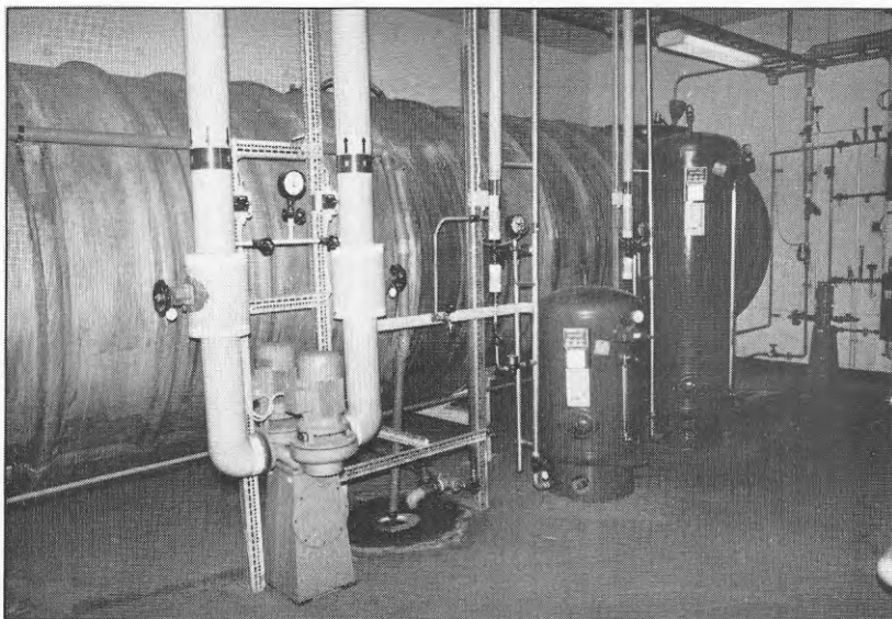
Fig 7.6 Ackumulatortank för spolvatten, ACK3 av glasfiberarmerad polyesterplast. I förgrunden ses cirkulationspump P3 och expansionskärnen för kondensor- och hetgassystem.
