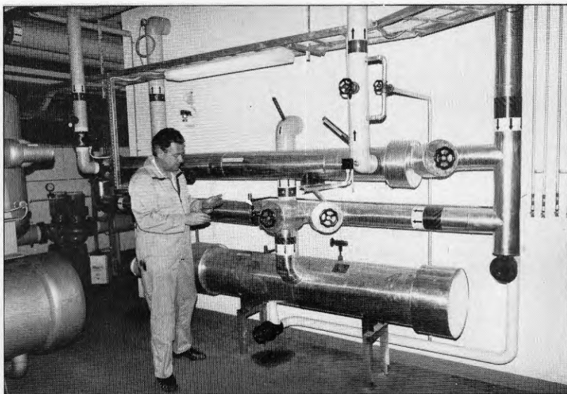
Fig 4.1 Den övre tubväxlaren på bilden betecknas HVX1. Värmväxlaren nere vid golvet är KD4 inkopplad i kondensorsystemet.
