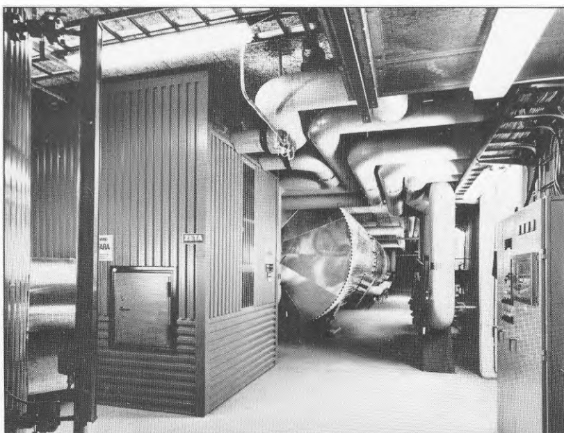
Fig 12.2 Interiör från värmecentralen med automatikskåpet till höger och två av ackumulatorerna delvis skydda av den nya högspänningspannan om 3 MW.
