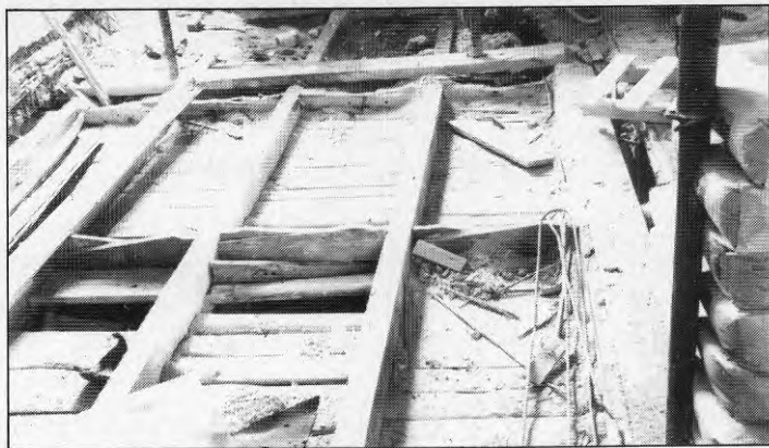
BILD 7. Fotografi av öppnat bjälklag med krysskolvning och lös blindbotten av utskottsvirke. Fyllningen har avlägsnats. (Ombyggnadsobjekt nr 5, Médea).
