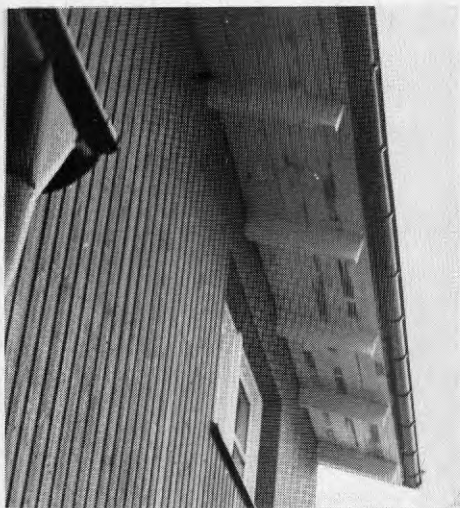
Figur 2. Missfärgning på takfotsluckor i gruppbebyggelse med enfamiljshus.
