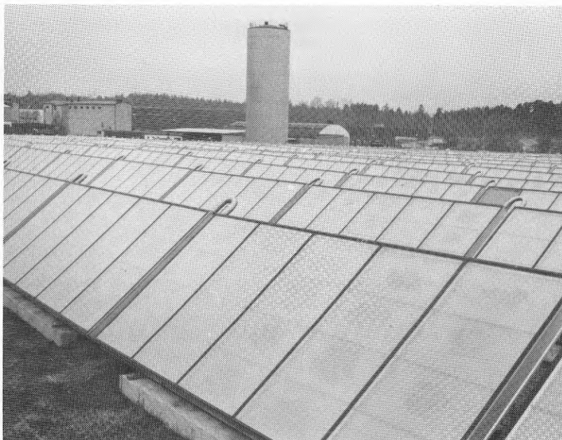
Figur 3.1 Solvärmeanläggningen från sydost med ackumulatorn i centrum.
