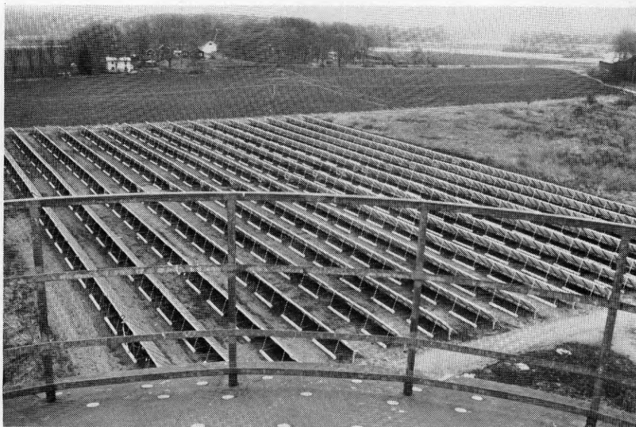
Figur 3.2 Solfångarfältet från toppen av ackumulatorn.
