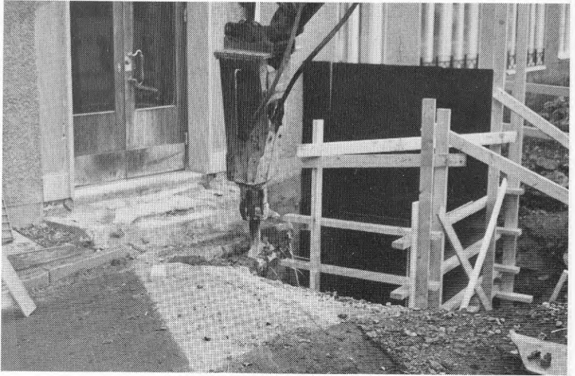
Konventionella hissar med schaktgropar placerade utvändigt som ledde till kostnadsövertäckningar för entreprenören.
