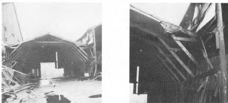
Fig.1 Kvarvarande del av nedrasat tak. Detalj av upplag.
