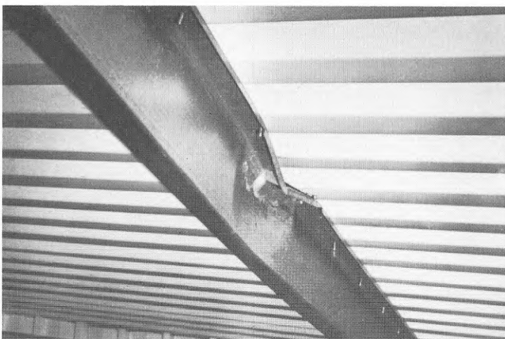
Fig. 1 och 2 Skadade takåsar, Z-balkar.
