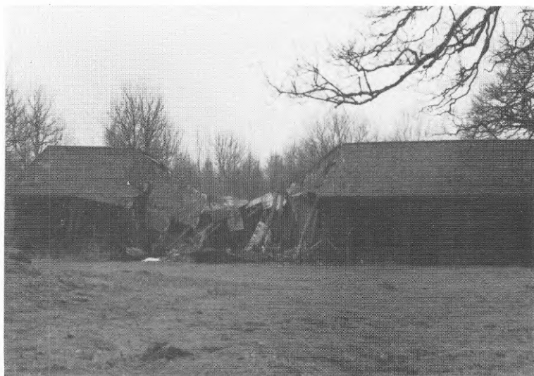
Fig. 3.4 Ras i vagnslider. Stolpverk av timmer med utvändig brädförning.
