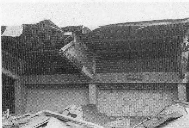
Fig. 3.2 Ras i rötskadad dansbana. Stomme av spikade ramar.
