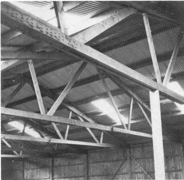
Fig. 3 Fackverkstakstolar. Skadad takstol med stötta.
