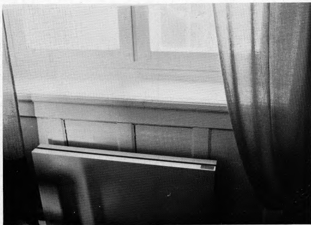
FIG 5.12 Målningskador. Blåsbildning i färgen p g a fuktigt trä eller dålig underbehandling. Sprickor i träet och i anslutningen mellan ramverk och fyllning är följd av permanentuppvärmning
