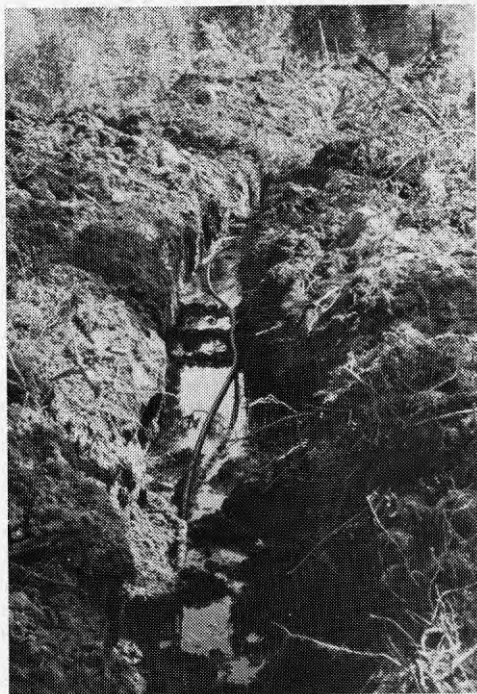
FIG 73 Hus 9. Jordvärmeslang. Totalt c:a 500 m på 1,2 m djup "Termia".
