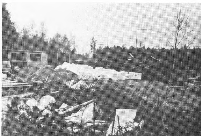
FIG 28 Hus 13, 14. Lagring av cellplast.
