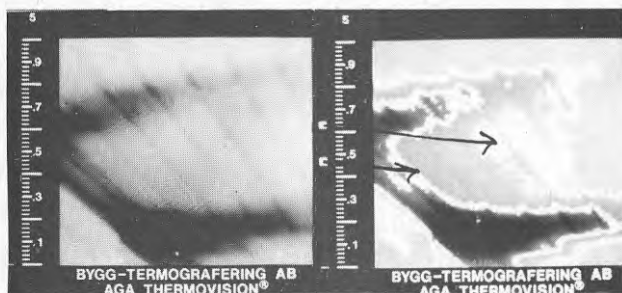
FIG 90 Termogram. Ytparti vid takvinkel. Nedkylning i takyta pga att kall luft läcker in i bjälklagskonstruktionen. (Hus 2. t_u -6^\circ , t_i +20^\circ , p -10 \text{ Pa} ) u
