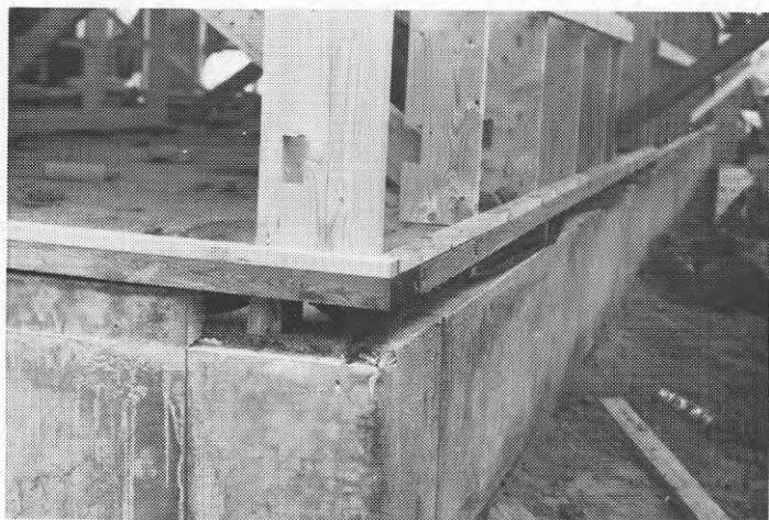
FIG 21 Hus 1. Grundplattan hade ett hörn 10 cm lägre än övriga. Syllen måste pallas upp.
