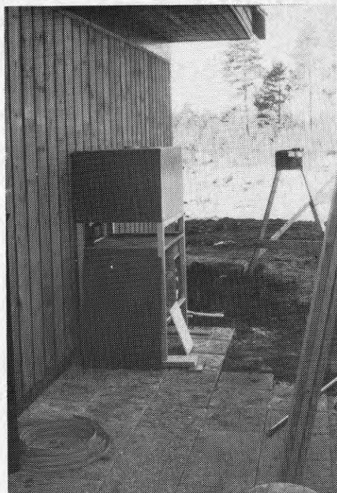
FIG 74 Hus 1. Luftvärmepump "Autoterm".
