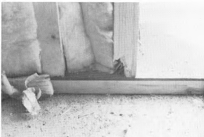
FIG 45 Hus 9-12. En mellan reg- larna inpressad för stor mineralullskiva kan ge e luftspalt med luftrörelse - drag.
