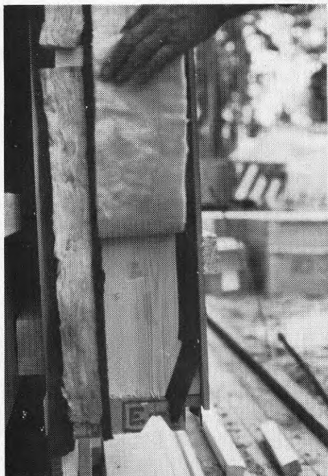
FIG 41 Hus 7, 8. Även lösningen av skarvarna i plan mel- lan elementen var sådan att det var svårt att få isoleringen bra.
