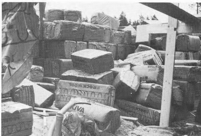
FIG 26 Hus 1, 2. Mineralullen lagrades länge under bar himmel utan annat skydd än emballaget och med de undre lag- ren i vattenpussar.
