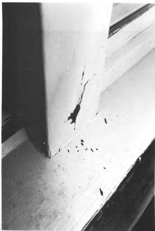
Bild 5. Rötskada i nedre del av mittpost.
