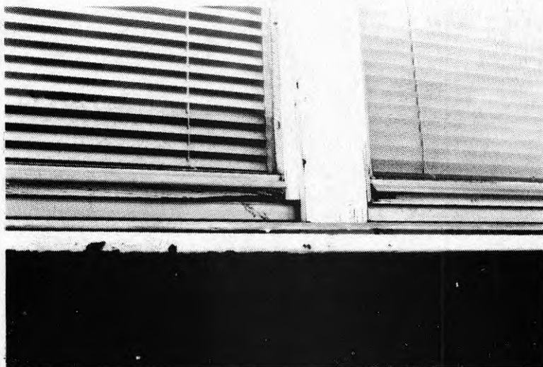
Bild 6. Rötskador i ytterbågens understycke.
