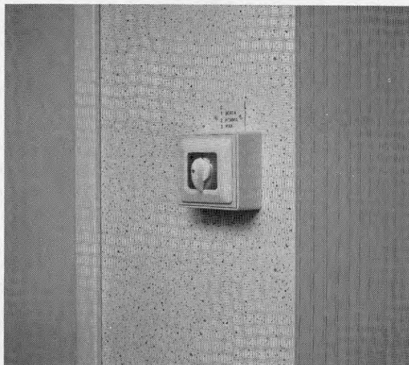
Bild 3.2 E Vred för styrning av ventilation.
