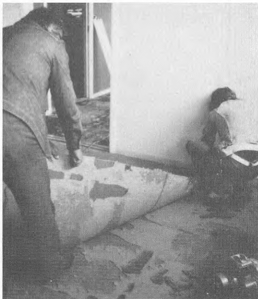
Bild 14 Utrivning av linoleum lagd på betong- golvpapp som fastgnidits mot underlaget med kallasfalt.
