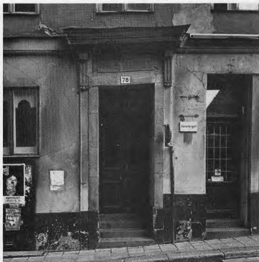
Fig 78. Sättningsprickor vid entrén. Deucalion nr 2
