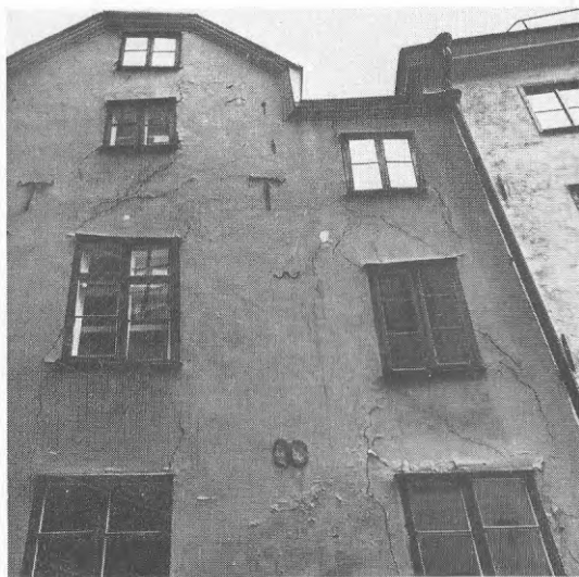
Fig 75. Sättningsprickor i fasaden mot Österlånggatan. Orpheus nr 1
