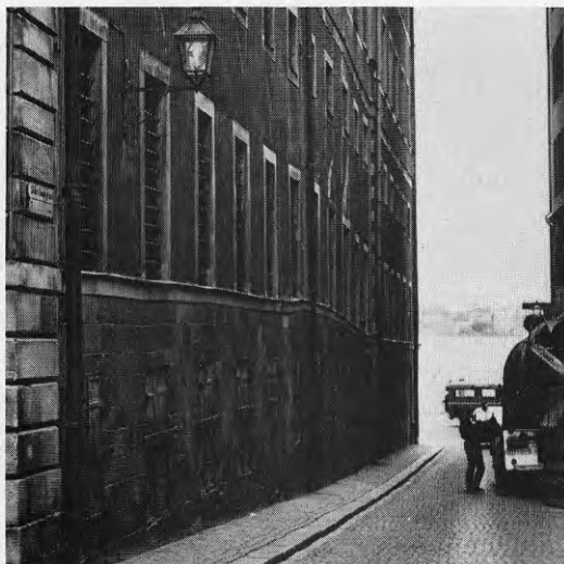
Fig 80. Listen över bottenvåningen buktar på grund av ojämna sättningar. Pluto nr 1
