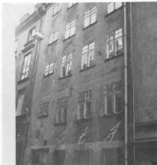
Fig 85. Sättningssprickor i fasaden. Deucalion nr 6
