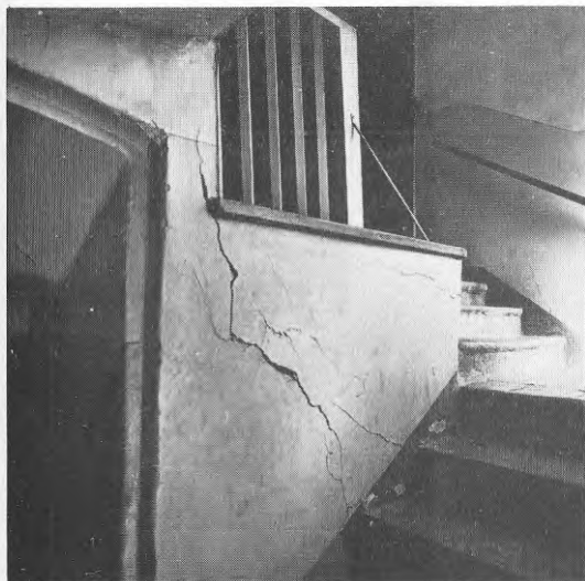
Fig 76. Sättningskador i trapphuset Fastigheten är nu upprustad och grundförstärkt. Marsyas nr 10
