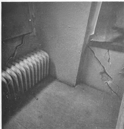
Fig 82. Invändiga sättningsskador i en butik. Thisbe nr 4
