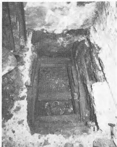
Fig 89. Äldre "vattentät" golvkonstruktion i kv Glaucus 4.
