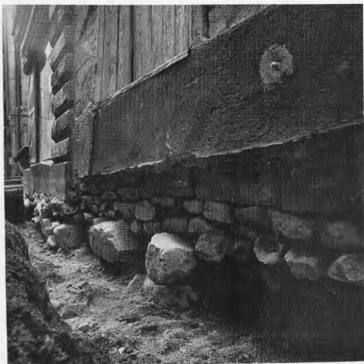
Fig 86. Buktande grundmur i kv Ganymedes 1 före grundförstärkning.
