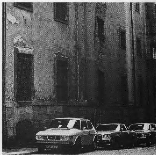
Fig 81. Omfattande skador på grund av ojämna sättningar. Proserpina nr 3
