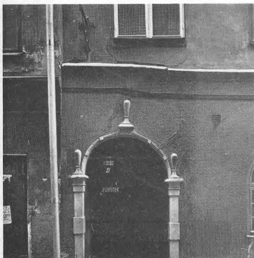
Fig 74. Sättningsprickor i fasaden mot Bredgränd. Orpheus nr 5
