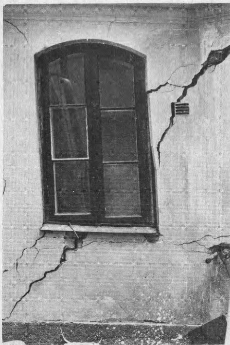
Fig 5. Exempel på svår sättnings-skada.
