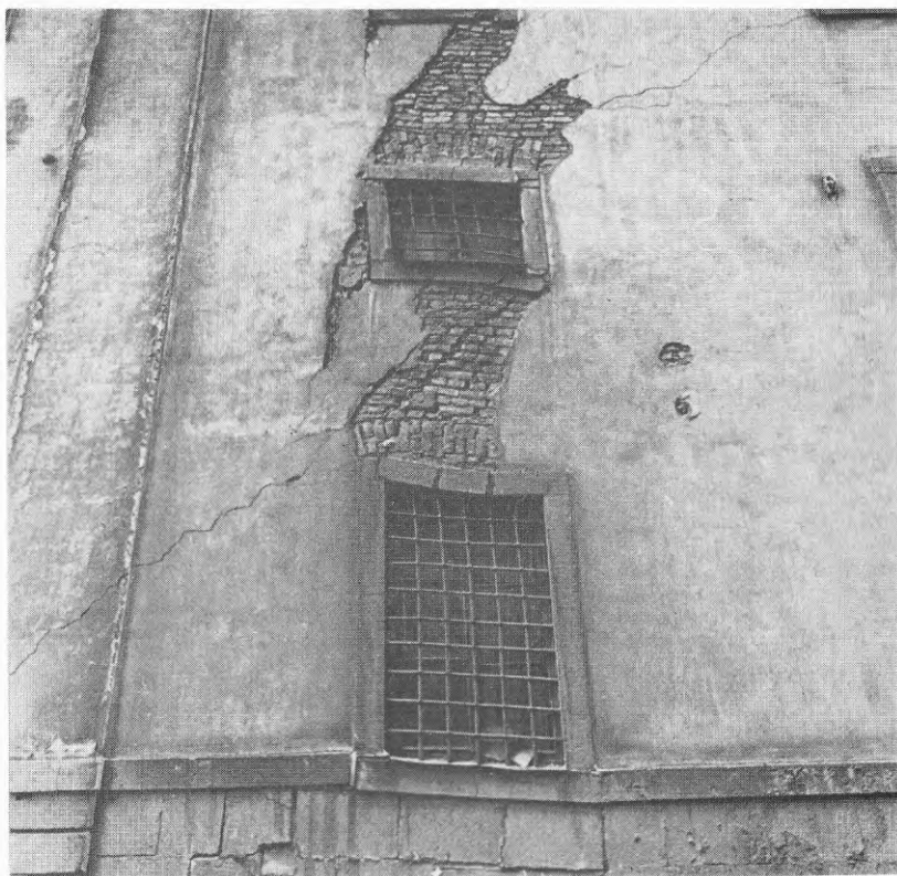
Fig 72. Stor sättningsskada i kv Proserpina (fasad mot Norra Bankogränd).
