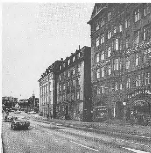
Fig 84. Byggnaden lutar till följd av ojämna sättningar. Avvikelsen från lodlinjen vid takfoten var 1943 0,58 m och 1976 0,7 m (lutning ca 5 %). Cadmus nr 1 (grundförstärkt år 1979)
