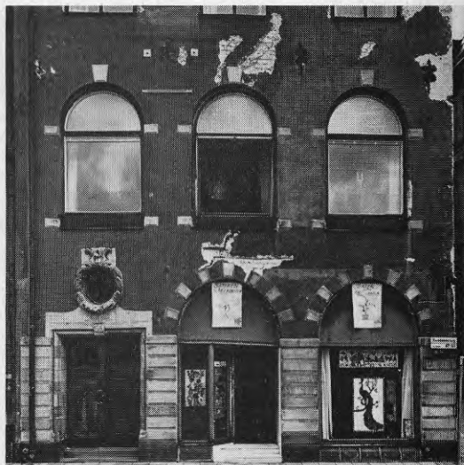
Fig 79. Sättningsprickor i gatufasaden. Typhon nr 18
