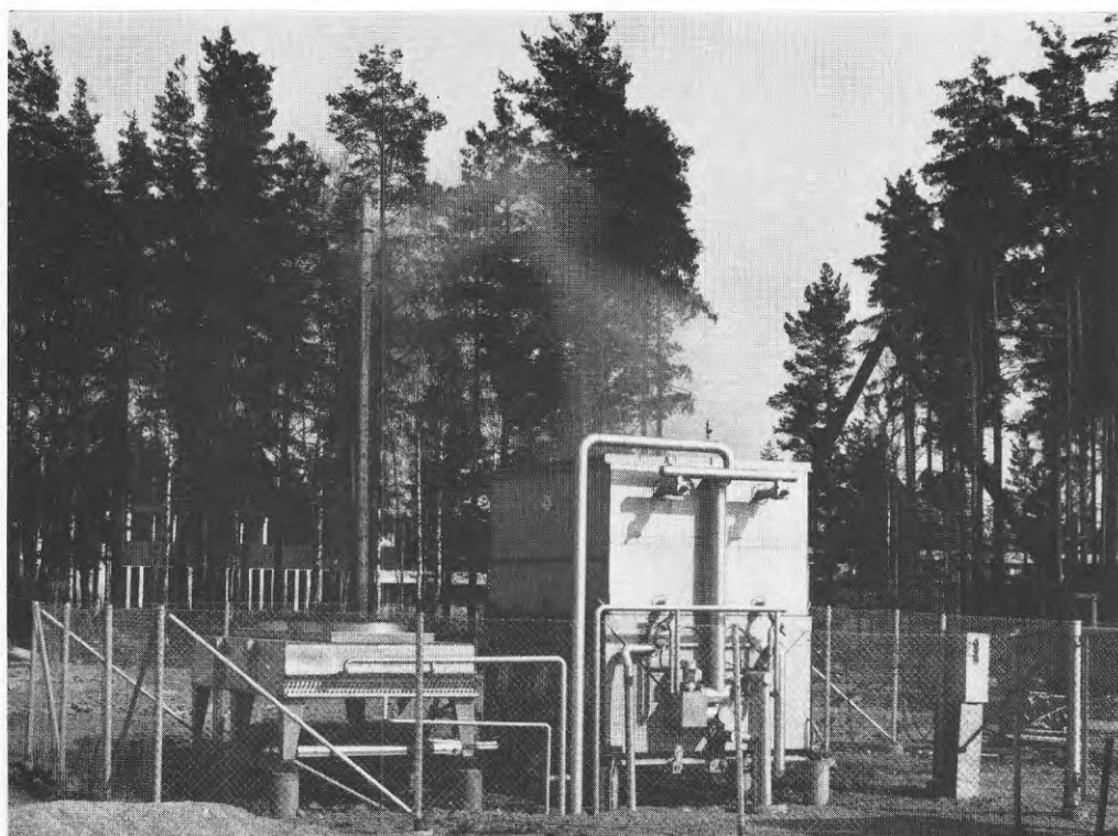
Figur 3.2. Uteplacerade kondensorer, den vänstra för ishallen och den stora högra för bandybanan.
