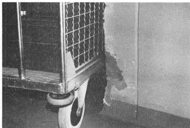
Figur 3.5.1 Exempel på skadade partier av putsad betongvägg, dubbla gipsskivor respektive gasbetong i utrymmen med trucktrafik.
