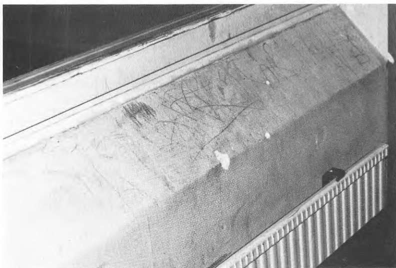
Figur 4.2a Strömbrytare på putsad vägg vilken skadats upprepade gånger av sparkar.
