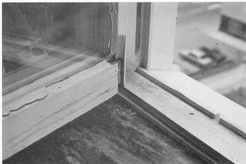
Upplöst limfog med förskjutningar hos fönsterbågens bottenstycke. Ett flertal rutor har lossnat och fallit ned utanför huset.
