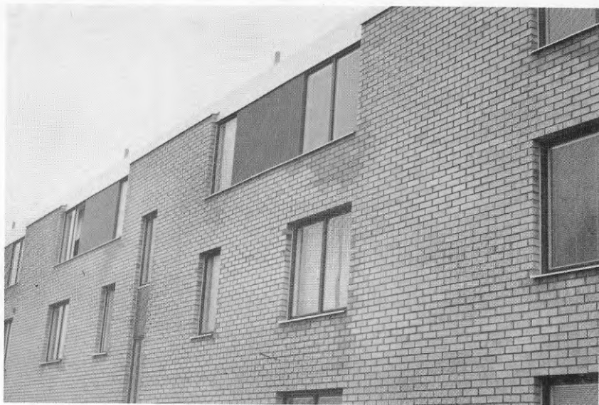
Fuktskadad yttervägg kring fönster under olyckligt utformad takfot. Den ofrånkomliga rötan på fönsterkarmens väggsida blir synlig så småningom.
