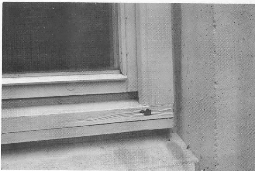
Tämligen långt framskriden röta hos karmbottenstycket med påbörjad målningsavflagnig.
