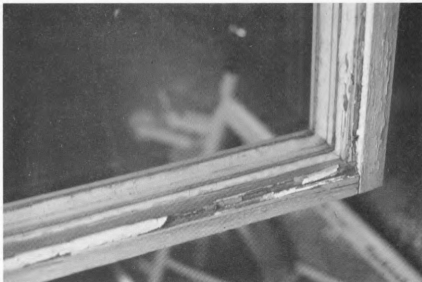
Skadad kittfog med röta i fönsterbågen.
