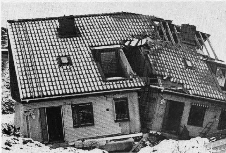
Foto AL8 Almhöjdsvägen 16 och 17. Typisk sönderbrytning lägenhetsvis.
