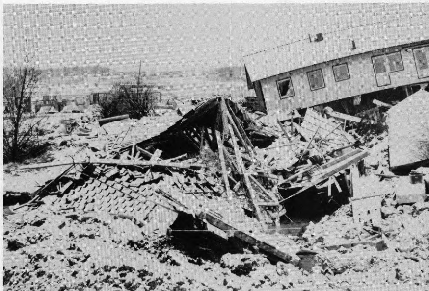
Foto SS8.2 Snarbergsstigen 8. Takkonstruktionen sedd från väster. Till höger ligger ena takfallet med överramstängerna upp och ner. Bakom resterna ligger Snarbergsstigen 6.
