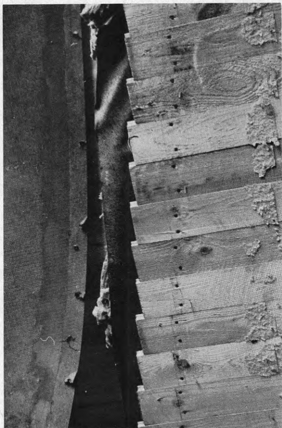
Foto TD31-32 Skjuvdeformation hos takpanel och board på taköverhänget vid Tånge- lund 7E. Fotot på takpanelen har tagits inifrån överhänget som visas på foto TD30.
