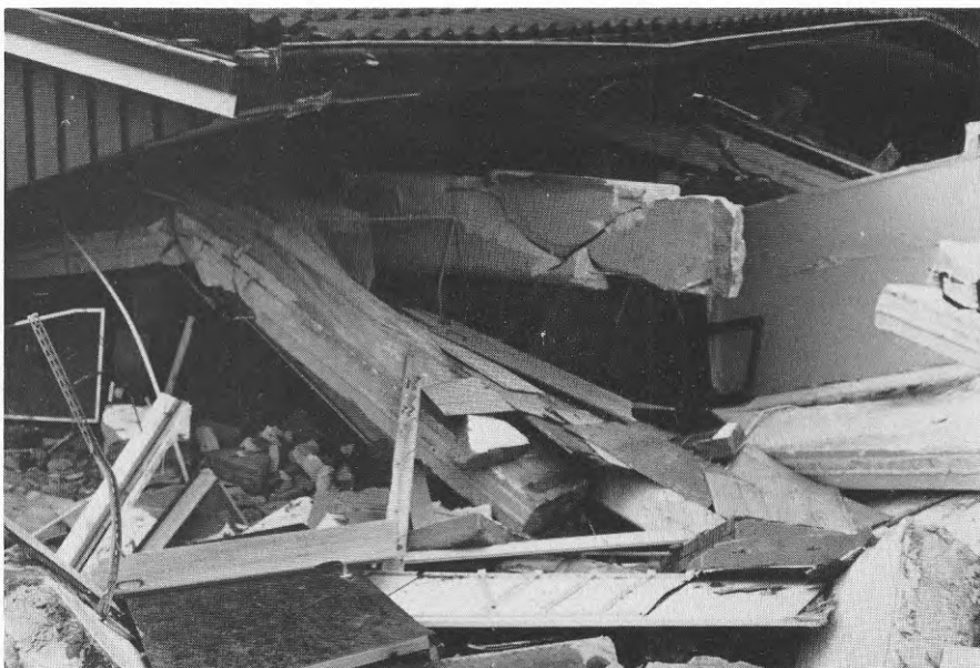
Foto SB3.2 Sydöstra hörnet av Snarberget 3. Skadade lättbetongelement.
