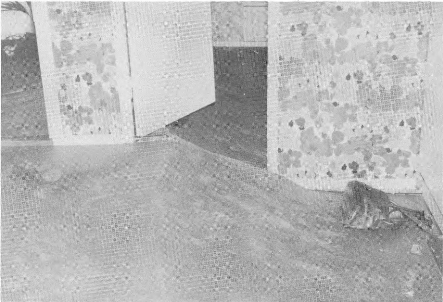
Foto SS5.4 Snarbergsstigen 5. Brott i bjälklaget.
