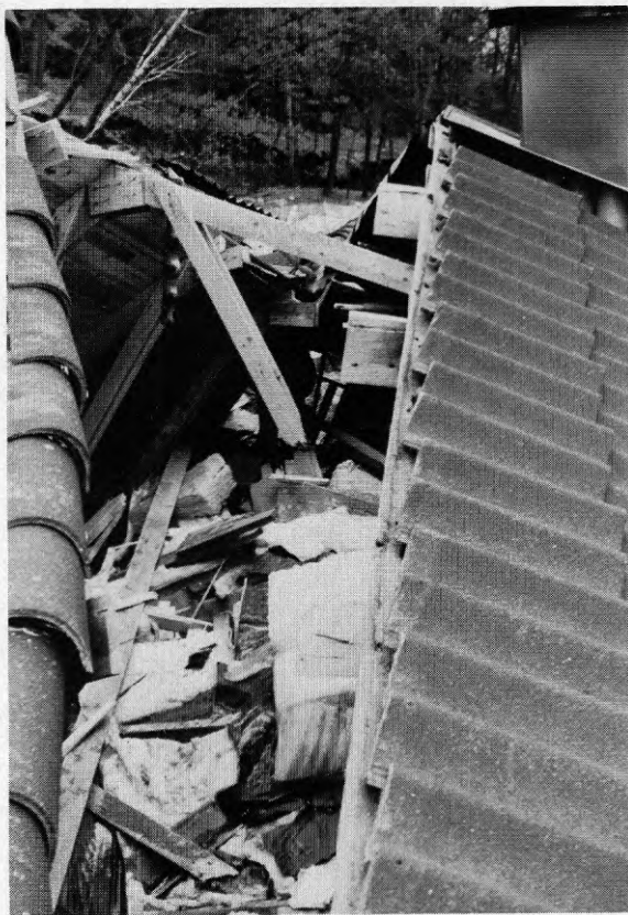
Foto SB3.3 Snarberget 3. Delningen i taknock. Brott har skett i nockskarv.
