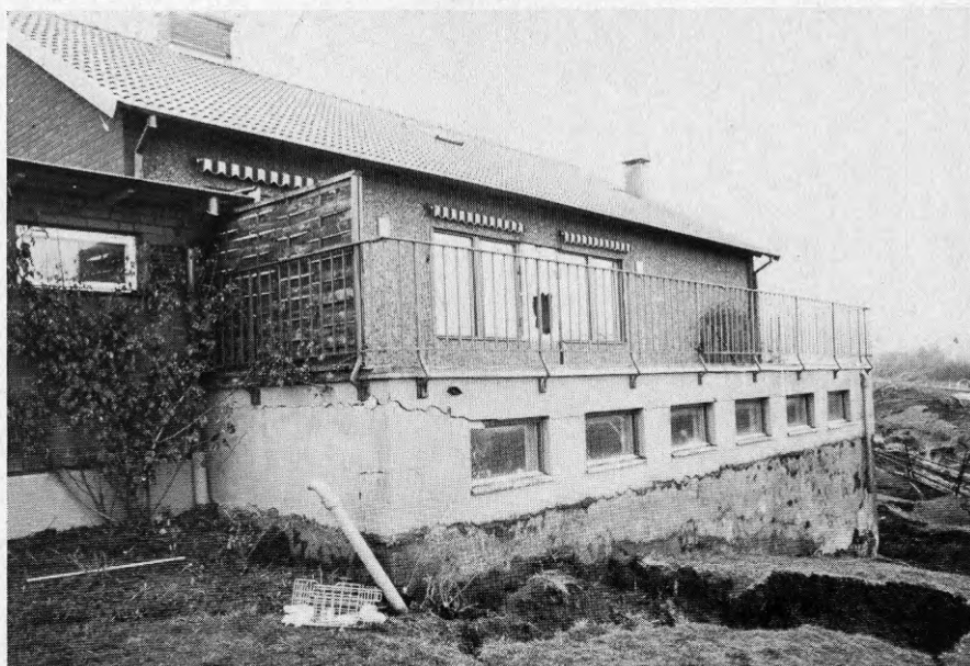
Foto SS7.2 Snarbergsstigen 7. Utbyggnad över poolen. Relativt kraftiga sprickor har uppstått i grundmuren.
