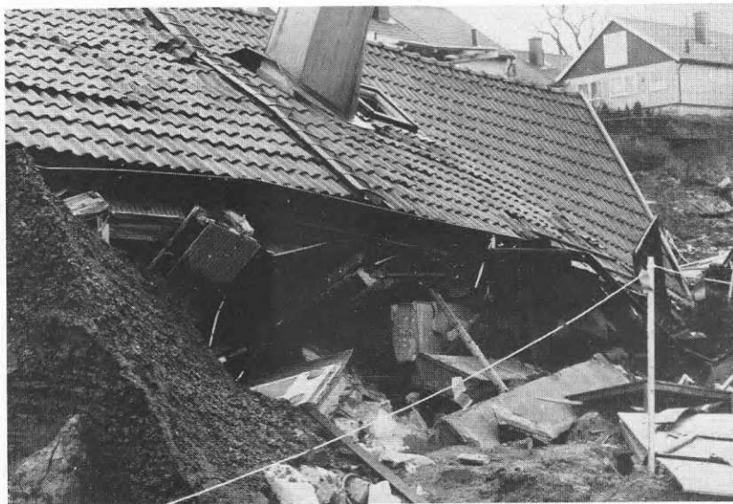
Foto TD19 Tångelund 4A. Väggelement och lättbetongelement ligger huller om buller under taket.
