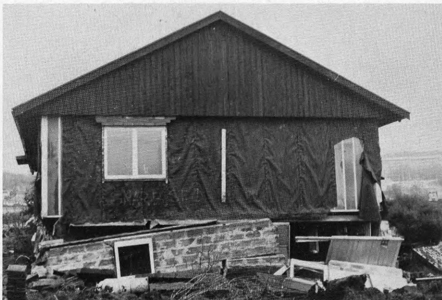
Foto SS1.1 Snarbergsstigen 1. Den mest skadade gaveln (västra) med nerfallen grundmur och fasadmur.
