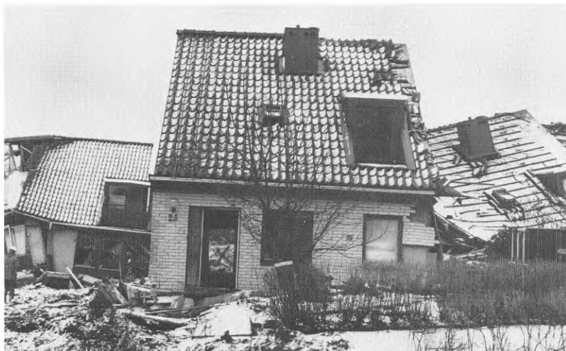
Foto AL12 Almhöjdsvägen 23 från framsidan. Huset ser relativt oskadat ut från det här sidan. Källaren var sönderslagen vid den lägenhetsskiljande väggen och vattenfylld. Att källaren var "oskadad" bidrog till att överbyggnaden klarade sig bra.
