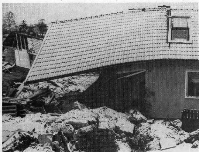
Foto TD5-7 Tångelund 3C. Överhäng över vardags- rummet där väggarna rasat. Räknat ovanifrån visas norra långsidan, östra gaveln och södra långsidan. Fotona på långsidan togs 12 jan 1978. Överhänget föll ner någon dag senare. På nedre bilden syns en spricka i takpanelen in- till takfönstret.
