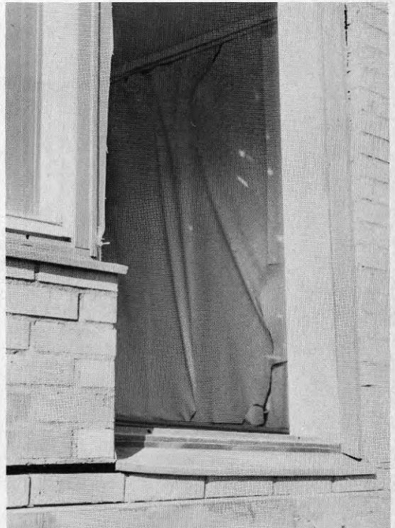
Foto TD44 Tångelund 10A. Hus på branten. Skjuvveck i tapeterna på grund av att huset satt sig i ett hörn. Vid tröskeln syns även sprickor i fasaden.
