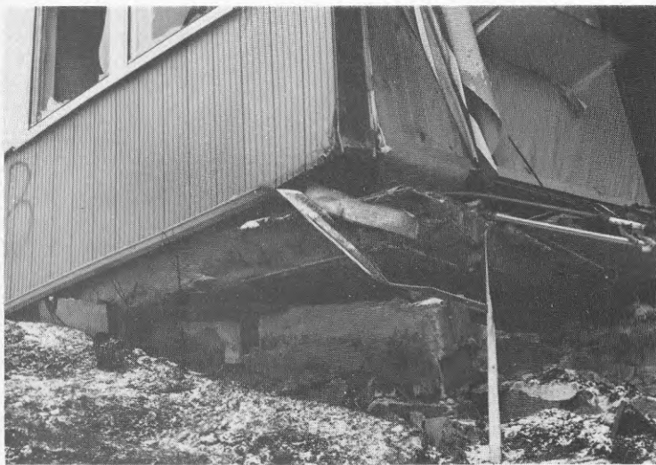
Foto TD23 Tångelund 1B Grundmuren har sjunkit ner och bjälklaget hänger fritt.
