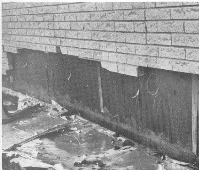
Foto AL35 Fastsättning av fasadmur med plåtbleck spikade i väggreglarna.
