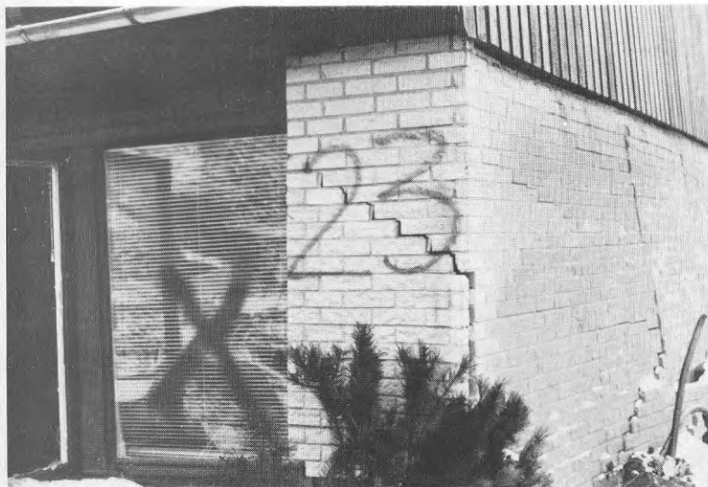
Foto AL37-38 Sprickbildning i fasadmuren på Almhöjdsvägen 23. Den högra bilden visar hur sprickan går både i fogar och tvärs genom stenarna.
