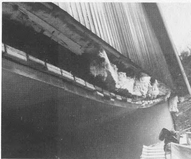
Foto TD39 Mellanbjälklaget över vardagsrum- met hänger i spänn- stagen.
