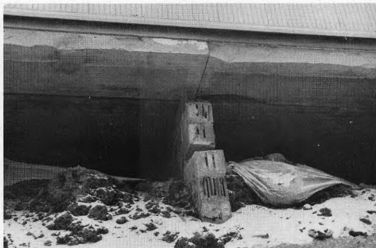
Foto TD21 Bjälklagslementen var skarvade över grundmuren. På bilden syns hur bjälklagslementen hänger kvar i huset trots att grund- muren gått sönder.
