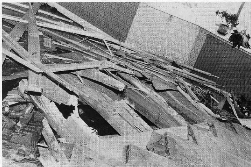
Foto TK3 Tuve Kyrkväg. Brott i bjälklagsbalkar orsakade av oljetankens upptryckning.
