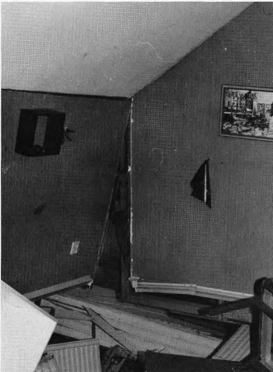
Foto TD43 Öppning mellan innervägg och gavel i övervåningen.
