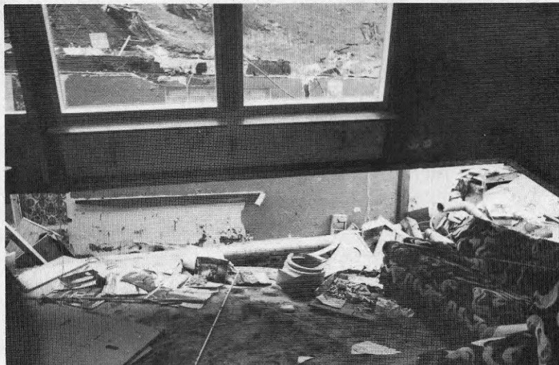
Foto AL57 Invändig bild som visar hur mellan- bjälklaget sjunkit ner när källar- väggen vält utåt. Våningsväggen hänger i takkon- struktionen.
