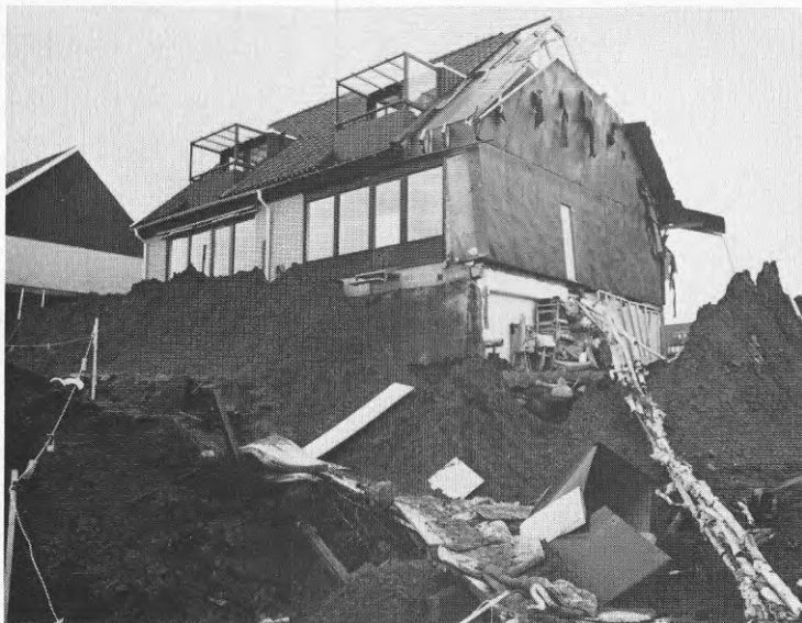
Foto AL5-7 Almhöjdsvägen 5 och 6 från tre olika håll. Den översta bilden är tagen i början av december. Den lägen- hetsskiljande väggen sitter fortfarande kvar. Husen har bara förflyttat sig något tiotal meter.
