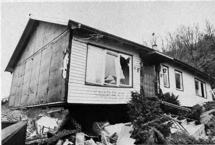
Foto SS6.1 Snarbergsstigen 6 sett från sydost. Den närmaste delen innehåller vardagsrummet som kragar fritt ut från hjärtväggen i källaren. Lägg märke till den starkt skjuvdeformerade fönsteröppningen.
