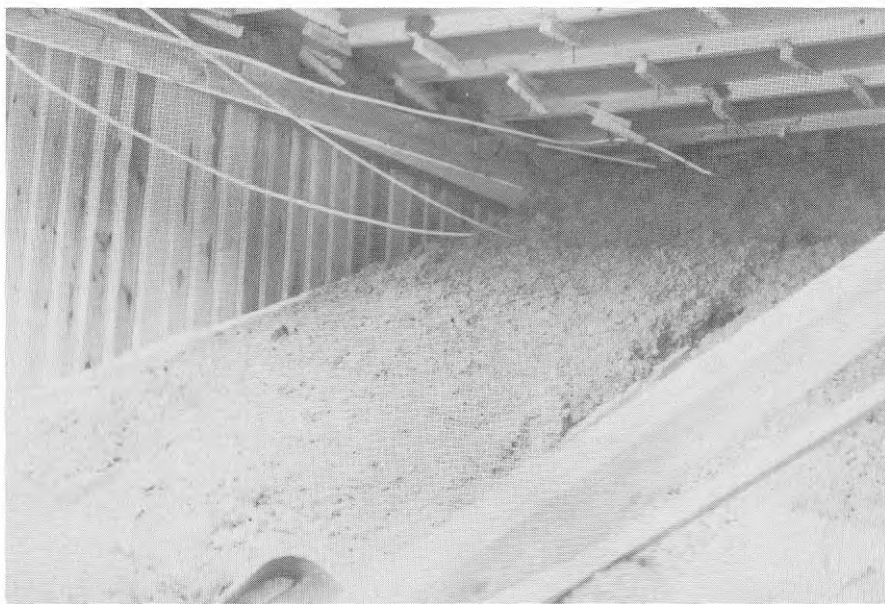
Foto SB6.3 Snarberget 6. Nedrasade betongelement fyllda med lös mineralull. Övergolvet med regler och täckning hänger kvar uppe.
