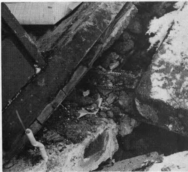
Foto AL53 Upphängningsjärn för entrétrappan
