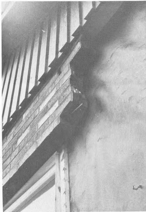
Foto SS1.3 Snarbergsstigen 1. Armering av tegelmur ovanför fönster.
