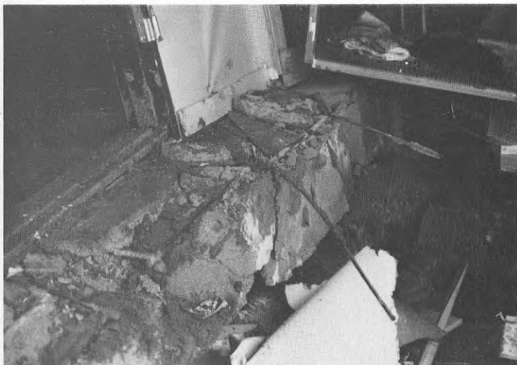
Foto TD25 Detalj av längdskarvning av bjälklags- elementen över den mellersta grund- muren med inmurade är- meringsjärn.
