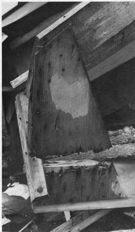
Foto AL32 Brott i takfotsförband hos en takstol.
