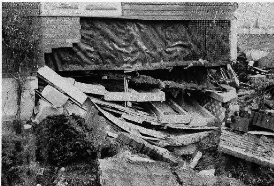
Foto SS1.2 Snarbergsstigen 1. Betongelementen föll ner när grundmuren försvunnit. Västra hörnet på fig. SS 1.1.
