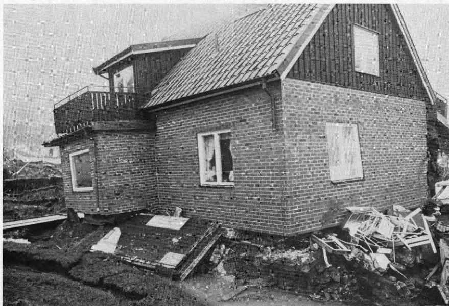
Foto Hlv1.1 Hedelundsvägen 1 från sydost. Bjälklagsplattan i entrén ligger utanför huset.
