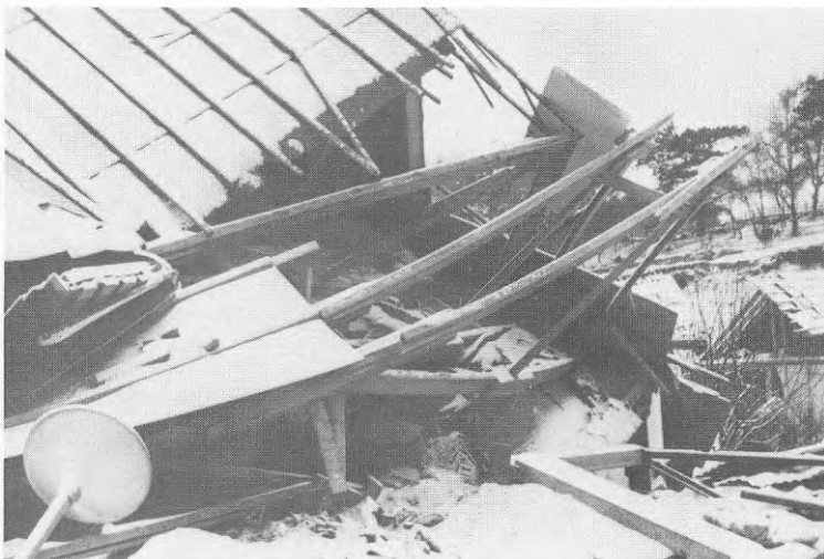
Foto AL25 Almhöjdsvägen 20. Takstolarna står i spänn på grund av att nederdelen fastnat i leran och resten av huset och grann- husen tryckt på.
