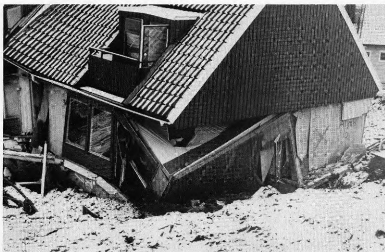
Foto AL10 Almhöjdsvägen 16. Nedbrytning av ytterväggarna i ena hörnet i var- dagsrummet.
