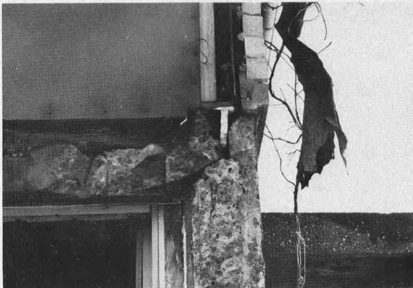
Foto AL39 Anslutning mellan bjälklag och källarvägg. Mitt på bilden syns en skiva cellplast som utgjorde kantisolering. Hörnet är delvis avskuret av kantisoleringen.
