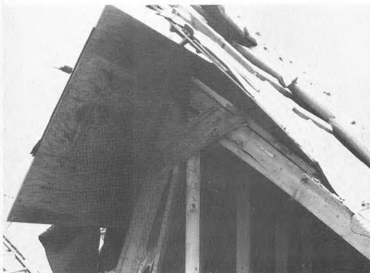
Foto AL30-31 Skadad takstol. Övre bilden visar övre delen av tak- stolen och undre bilden visar nedre delen men från en annan vinkel. Takinbrädning med amerikansk plywood framgår av den övre bilden.
