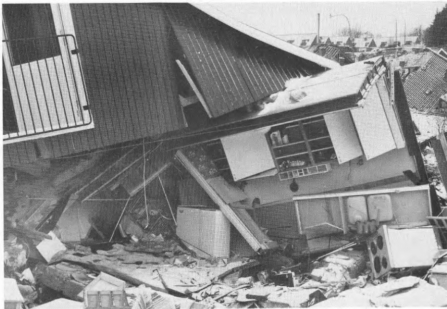
Foto TD18 Tångelund 4A. Taket vilar på bjälklagselement ovanpå köksytterväggen (långfasad). Gavelväggen har rasat bort.
