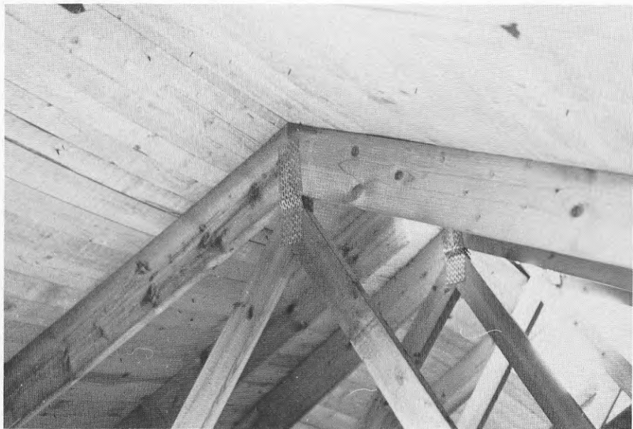
Foto SB1.4 Snarberget 1. Skadade spikplåtar.
