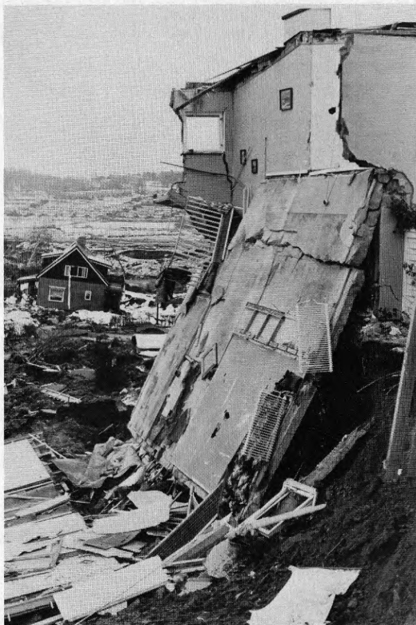
Foto TV7 Tångenvägen 5 M. Bruten mellanlags- platta. I bakgrunden skymtar Hedelunds- vägen 1.
