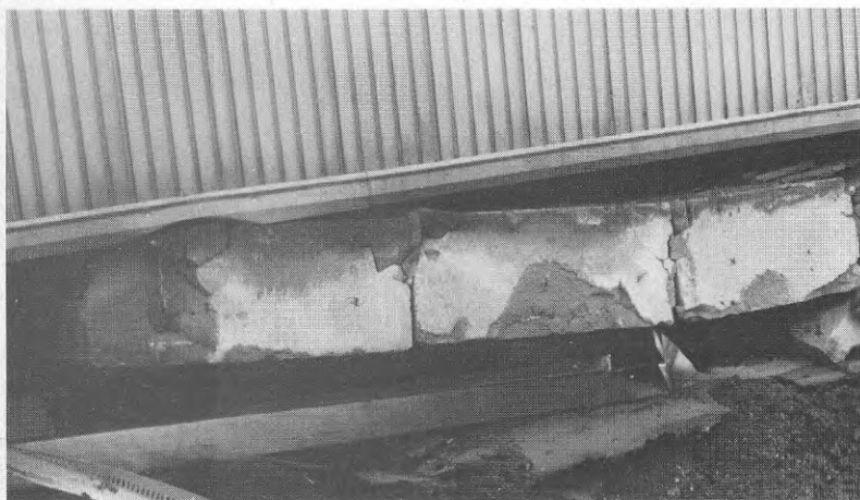
Foto TD24 Grundmurens bortfall har gjort att bjälklags- elementen sjunkit ner. Trots detta står väggen kvar odeformerad.
