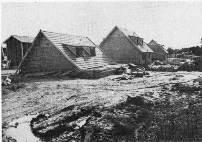
Bild 7.2.2 visar den raserade byggnaden sedd snett från Iovartsidan. Man kan konstatera att överbyggnaden bestående av taks kivor, mellanbjälklag och gavelspetsar hållit väl samman. Långväggen vettande mot vinden har lagt sig ned mot golvbjälk- laget så att gavelväggen i fallet brutits helt sönder.
