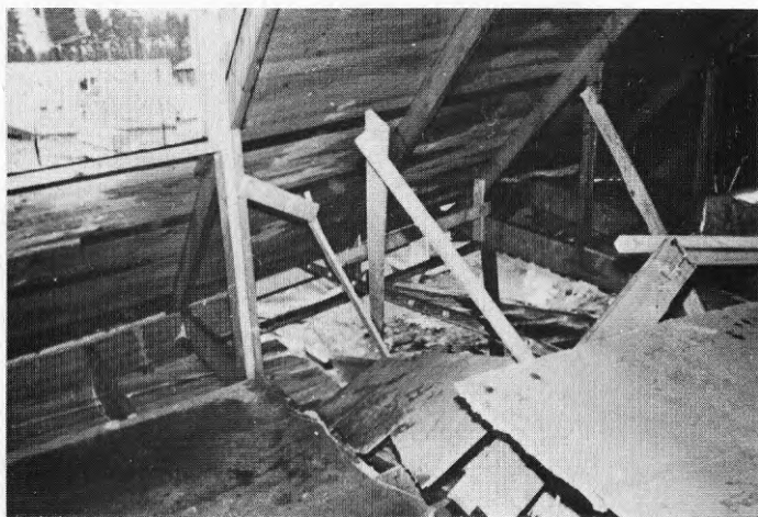
Bild 7.3.5 visar att det sönderbrutna mellanbjälklaget samt yttertaket lokalt fått stora deformationer utan att brytas sönder. Bilden hade varit delvis en annan om yttertaket bestått endast av ett "vattentak" med fribärande tegelläkt. Dock har det visat sig att även i sådana fall takkonstruktionen brukar vara väl sammanhållen även efter nedfallet.
