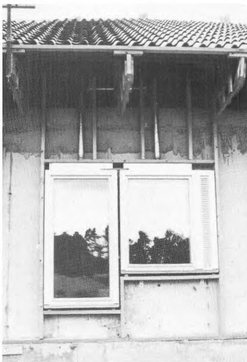
Bild 7. Husdel B, frånluftsfönster kopplade till ventilationssystemet.
