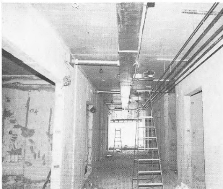
Bild 3. Husdel A, ventilationskanaler i korridors undertak.
