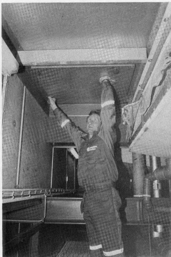
Figur 10.2 Inspektionsluckan till en av förångarfläktarna.
