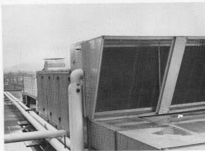
Figur 2.9. Foto av tilluftssaggregat i referensanläggning I i Jönköping.
