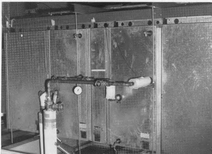
Figur 2.5. Foto av tilluftsaggregat i provanläggning I.
