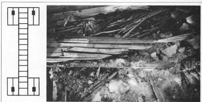
Fig 3. Limmade träbalkar av typ IAS har normalt ett I-tvårsnitt enligt figuren men varianter förekommer. De utgör en säkerhetsrisk som senast manifesterades i Umeå där taket i en gymnastiksal störtade in. Fotot visar en hopplagd del av underlåsen. Lamellerna var skarvade med schäfffogar som var mycket för branta. På bilden syns tre lamellskarvar inom 0,3 m.
