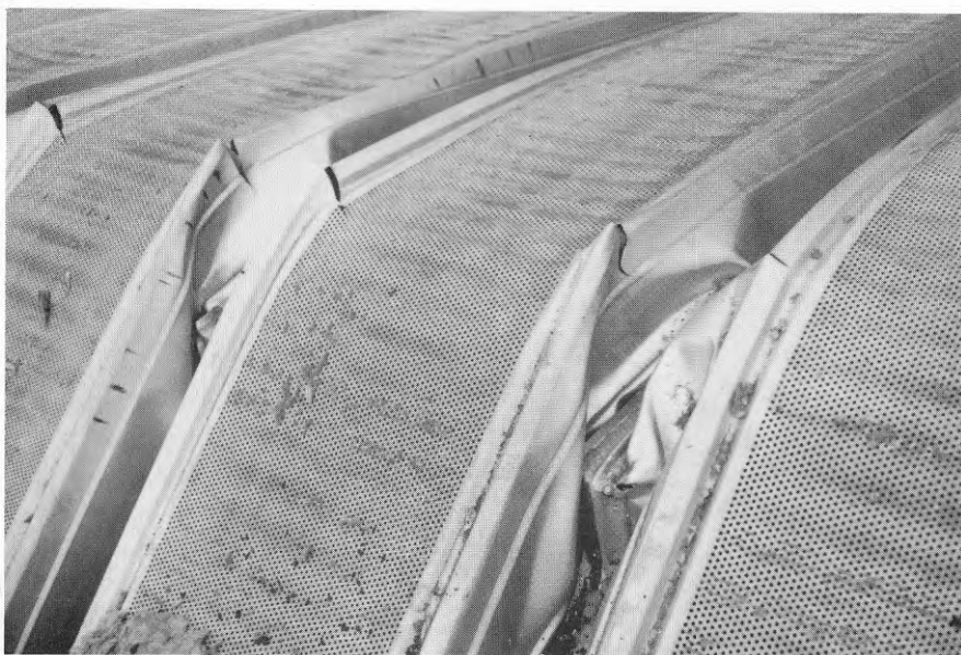
Figur 10.2. Buckling av takplåten över balkupplag.
