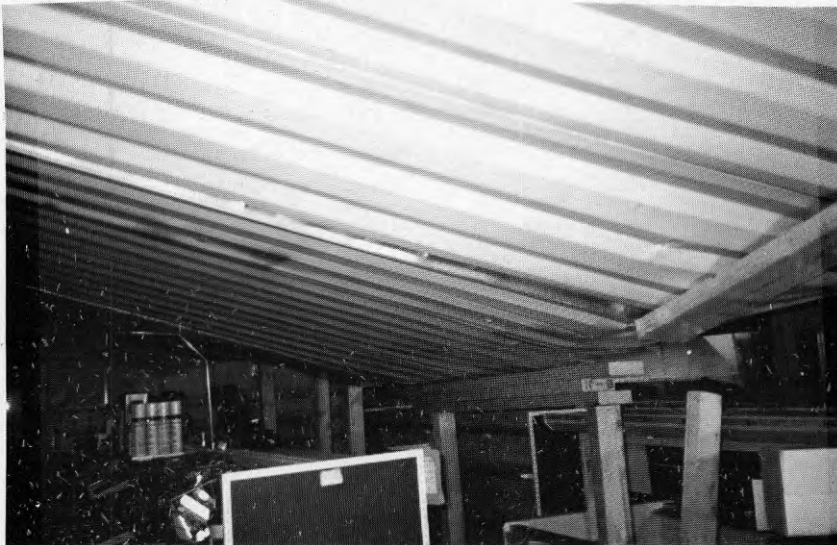
Figur 10.1. Stora nedböjningar i takkonstruktionen p g a snötyngden.
