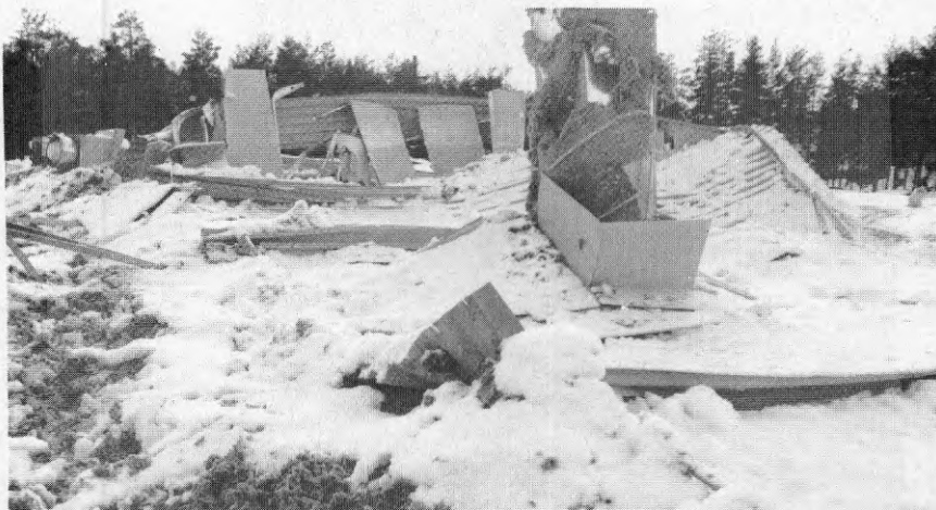
Figur 12.1. Totalkollaps av den 2500 m 2 stora takytan.
