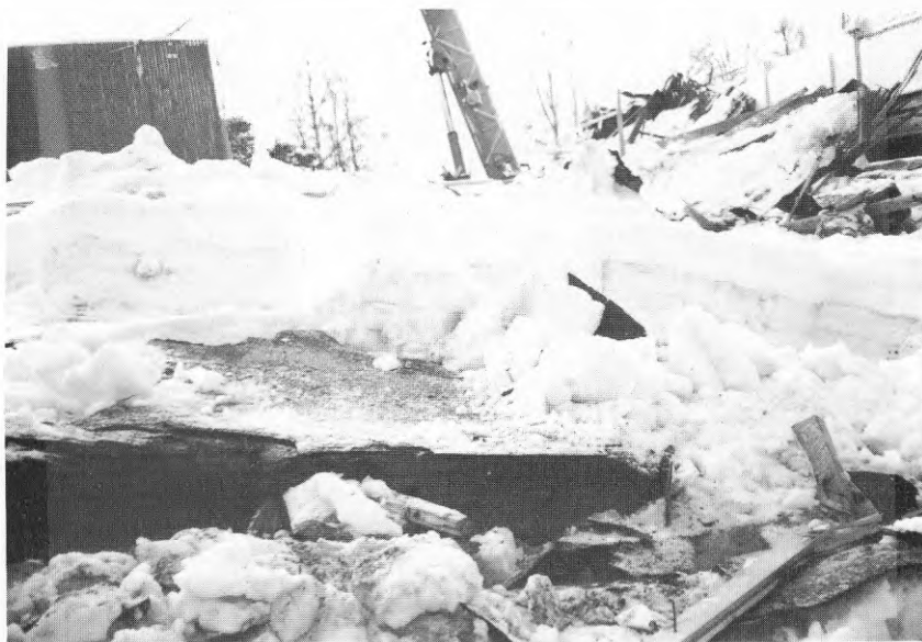
Figur 11.4. Fullständig kollaps av gymnastikhallens takkonstruktion.
