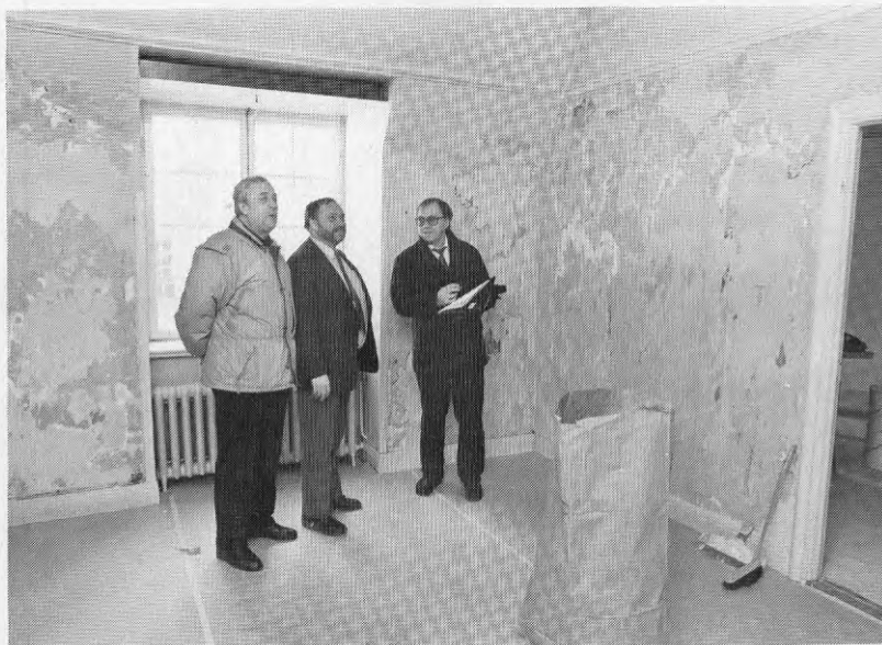
Fig. 4:1 Vardagsrummet. Hela lägenheten var hårt nedsliten och krävde omfattande åtgärder. Speciellt taket betraktades som svårt. Här diskuteras problemet mellan beställare, målarmästare och projektledare.
