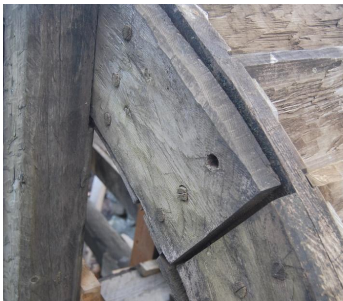
Figur 11. Skadad hjulring. (Zackrisson 2015, s. 3).
