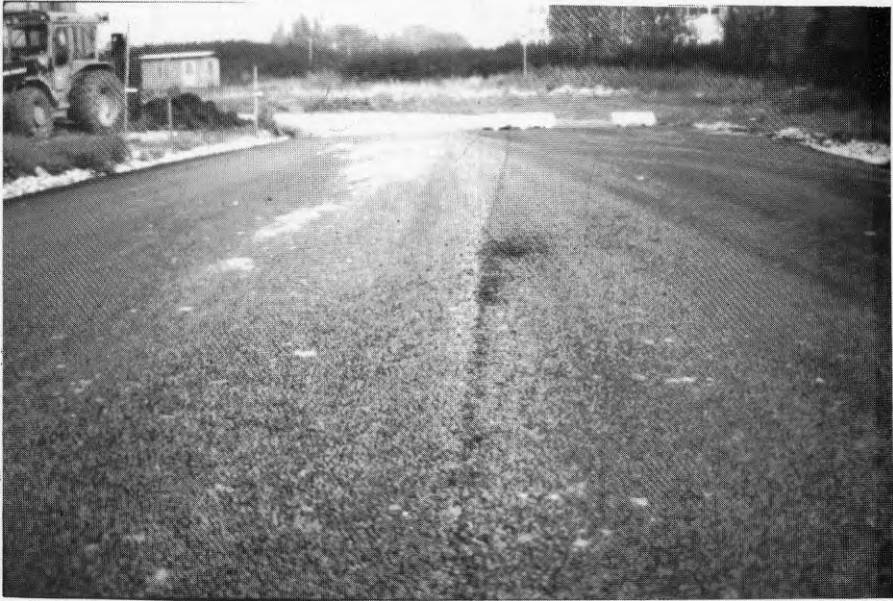
Figur 7.6:3 Dålig sammanhållning av beläggningsen i fogen mellan två utläggningsdrag.
