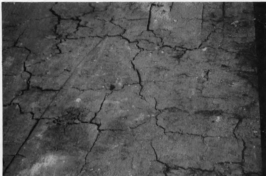
Figur 5:6 Sprickor i terrassen efter att ha torkat cirka 3 månader.
