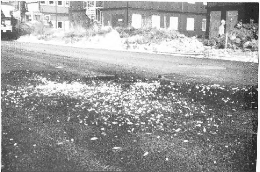
Figur 7.6:2 Söndrig överbyggnad i Ole Römers väg efter cirka 1 månads användning. Sektion 390.
