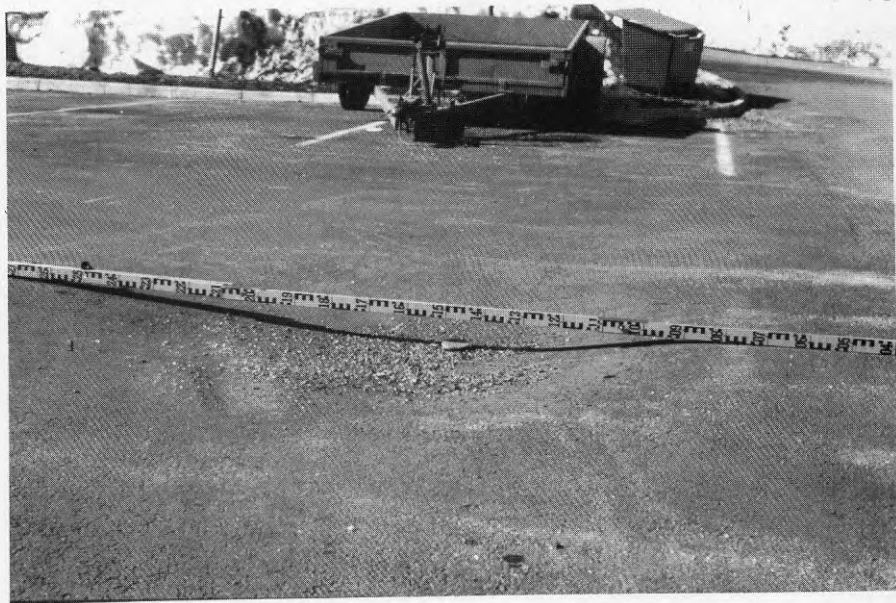
Figur 7.6:15 Ojämn tjällyftning på parkeringsyta med enhetsöverbyggnad i Finsta, Sundsvall.
