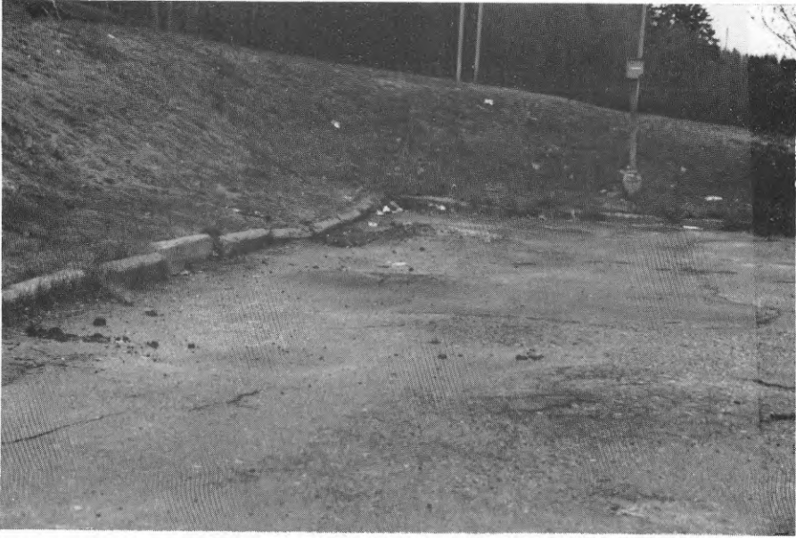
Figur 6:1 Tjälskadade ytor inom bostadsområdet Finsta, Sundsvall, innan ombyggnad.
