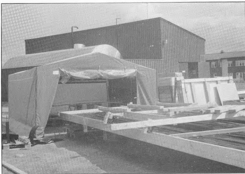
Fig 3.11 Tältet där glas/gummilist/teflon monteras för att sedan transporteras ut på solfångaren med vagnen i förgrunden.
