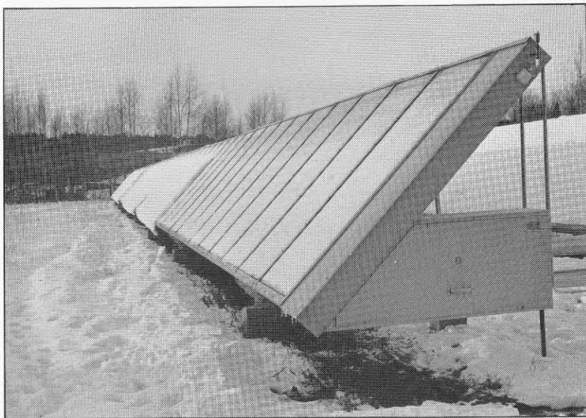
Fig 6.4 Den första snön på hösten rasar behändigt av solfångarna.
