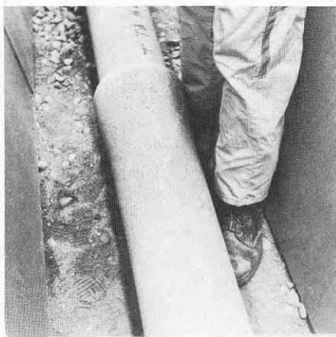
Figur 4.19. Förarbete rörgrav, b = 60 . Fotutrymme med 150 mm betongrörledning i grav enligt Mark-AMA. Endå möjligheten att förflytta sig i graven är att gå grensle över rörledningen.
