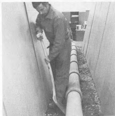
Figur 4.25. Understoppning, b = 70 cm, \varnothing 150 mm betong. Dåligt utrymme som inte möjliggör en effektiv understoppning. Slår emot slänten med armar och ben.
