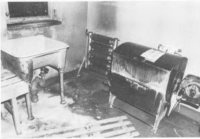
Figur 4.12 Tvättstuga i hus från 1944 (ursprunglig installation)
