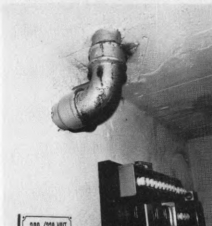
Figur 4.2 Exempel på synliga rostangrepp på målade gjutjärnsrör
