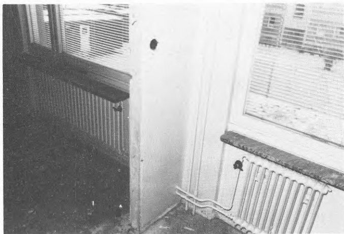
Figur 4.18 Rörinstallation i hus från 1953. Värmestammarna är synligt monterade.
