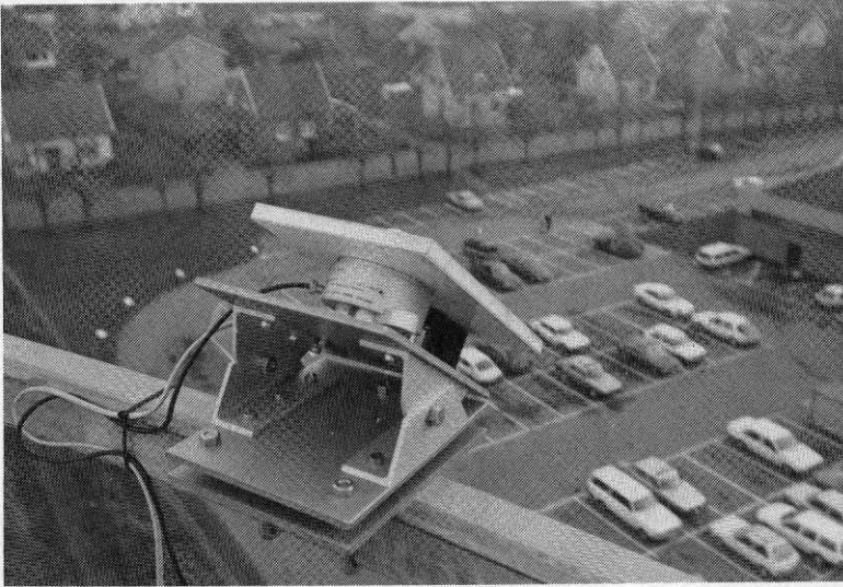
Figur B 2.2 Pyranometer med fläktlåda är placerad på räcket högst uppe på ackumulatortanken.
