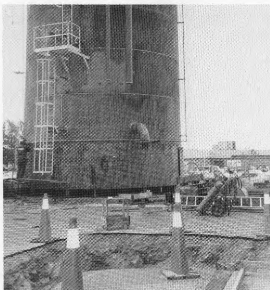
Figur 5.12 Tanken under byggnad.
