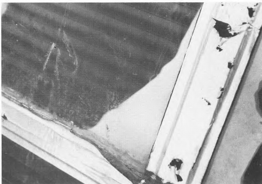
Smuts på utsidan av täckskivan i en anläggning nära en trafikled.
