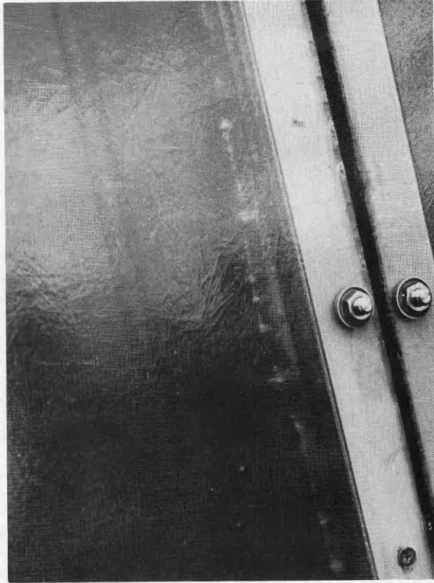
Kantisolering (polyuretan med aluminiumfolie) som lossnat till följd av temperaturrörelser i solfångarkonstruktionen.
