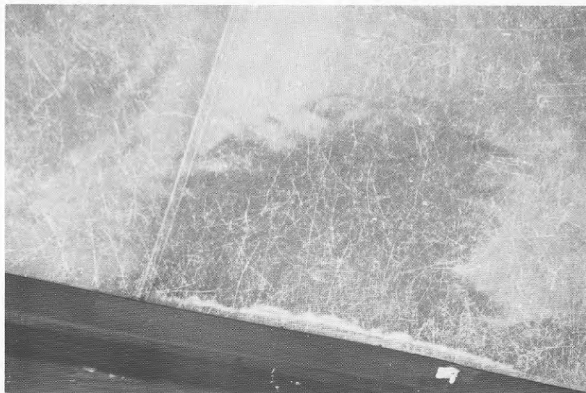
Solfångare med absorbator av koppar. Korrosionsangrepp på absorbatorns nedre kant.
