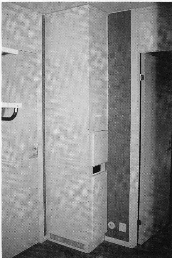
Figur 4.5 Luftvärmeaggregat monterat i hallen i lägenhet 6C. Galler för återluft nedtill. Inbyggnad med laminatskivor. Demonterbar front upptill.
