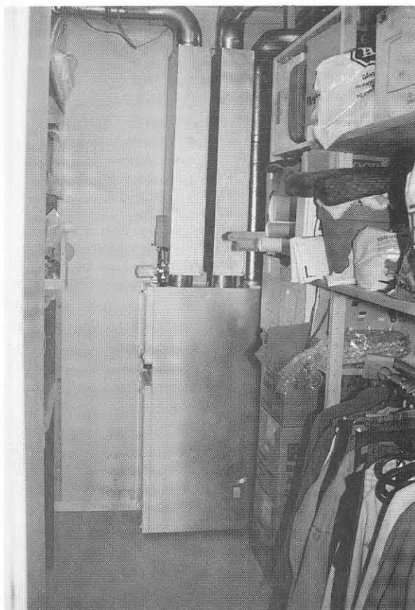
Figur 4.6 Luftvärmeaggregat monterat i klädkammare i lägenhet 6E. Rektangulära ljuddämpare ovanför aggregat
