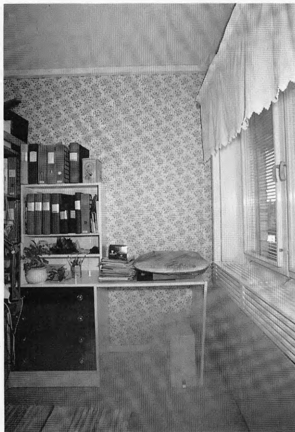
Figur 4.10 Tilluftsdon vid luftburen värme i form av textilslang bakom fönsterbänk i lägenhet 6E. Rektangulära tilluftskanaler av aluminium vid tak och fönsterfoder.
