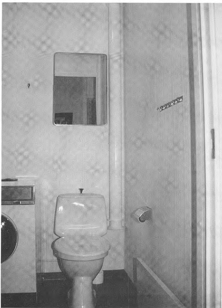
Figur 4.8 Tilluftsdon i badrum med luftburen värme.
