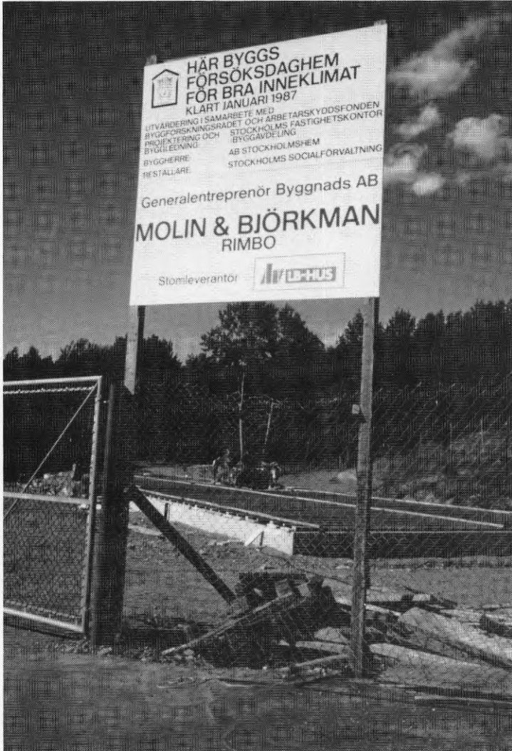
Tomten i kvarteret Molntappen, belägen i Skarpaby, utgör den nordöstra delen av ett stort nybyggnadsområde på Skarpnäcksfältet.
