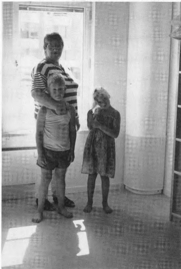
Referensbarnstugan Understen har deplacerande ventilation. På bilden syns ett av lågimpulsdonen som släpper in något under-tempererad tilluft i golvnivå.
