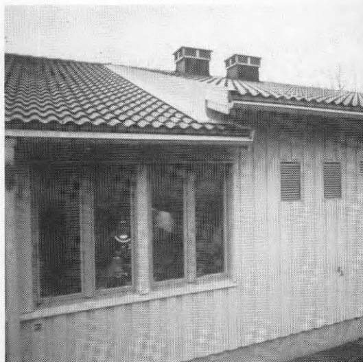
Uteluftsintagen till ventilationen är placerade på norrfasaden, väl avskilda från avluftsutsläppen vid taknock.
