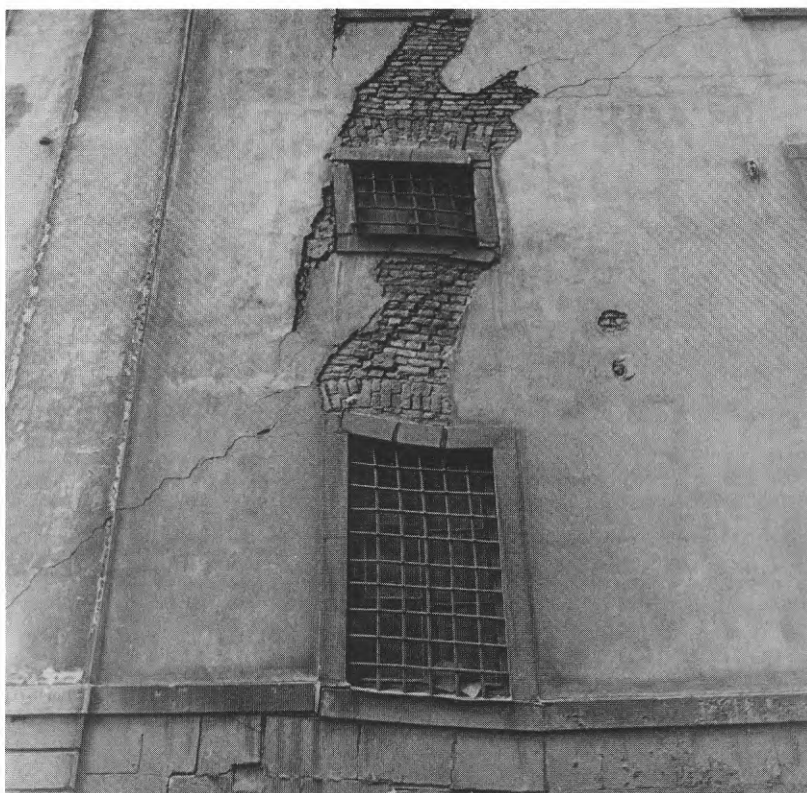
Sättningskadat hus innan grundförstärkning (kv. Proserpina).
