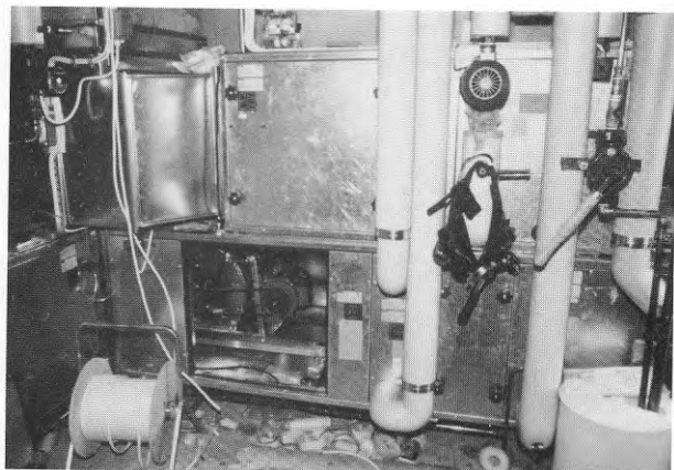
FIG 9. Apparaturrum med del av växlare
