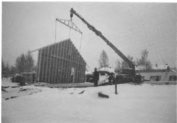
FIG 17-19 Tillverkning av vägg- sektioner. Stommonte- ring påbörjas. Hus A under tak till jul
