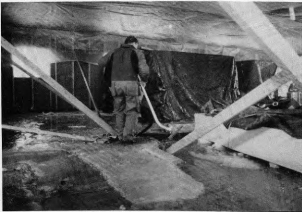
FIG 35. Fukten på betongplattan orsakade extra lång uttorkningstid.
